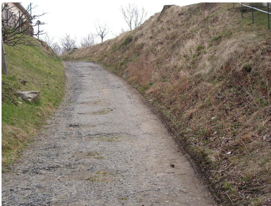
Obrázek 19 Nevyhovující šířka cesty
