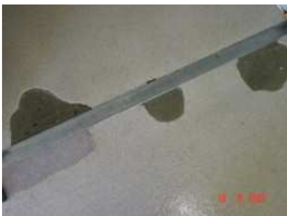
Obr. č. 8: F – stavebně technická narušení prahu u vstupu do nasolovací chladírny a narušení nátěru opláštění v prostoru nástřiku.
