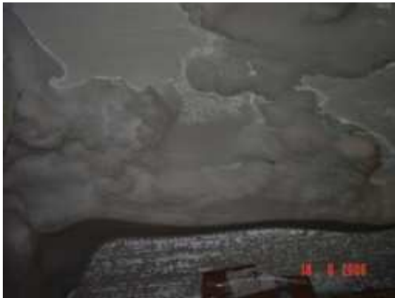
Obr. č. 1: B – nedostatečné odmrazování mrazírny, námraza na stropu a stěnách.
