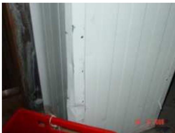
Obr. č. 7: F - stavebně technická narušení obložení stěn.
