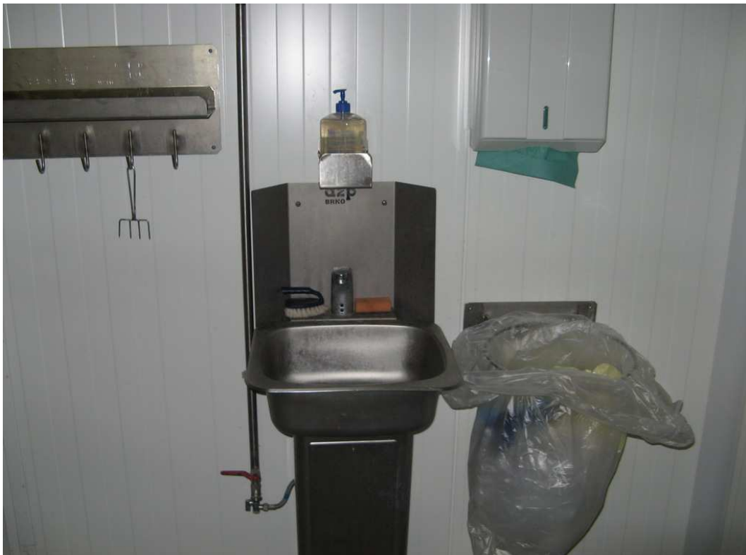
Obr. č. 15: Bezdotyková baterie s papírovými osuškami na pracovišti
