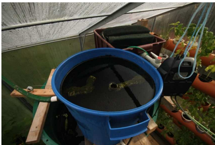
Obr. 35. Směrování proudu a odvod předčištěné vody (vlastní foto)
