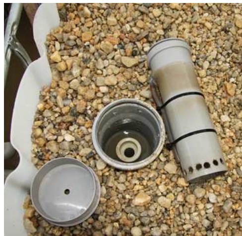
Obr. 66. IBC kontejner použitý pro stavbu systému (vlevo), vertikální drenáž s autosifonem (vpravo), (vlastní foto)
