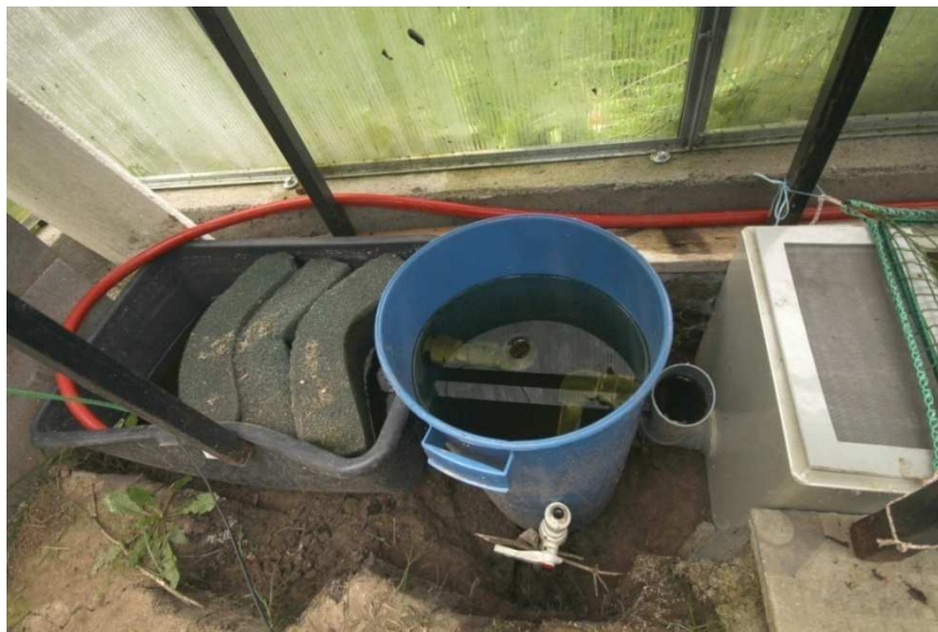
Obr. 56. Filtrační část systému (vlastní foto)
