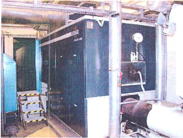
Obr.2.2 - Měřený kotel Verner 800 kW
