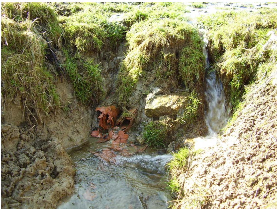
Příloha 10. Nefunkční drenážní vedení odkryté vodní erozí, Jenín 1
