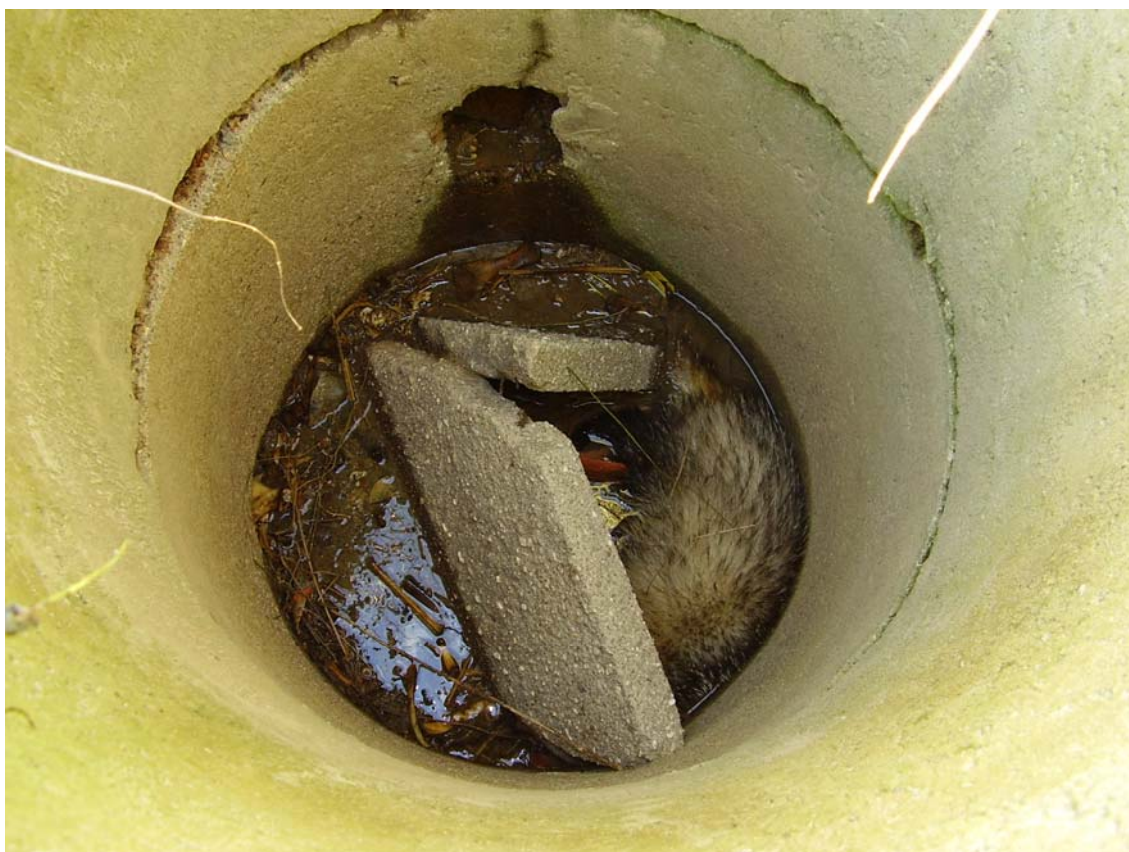
Příloha 12. Drenážní šachtice bez poklopu – past pro zvířata
