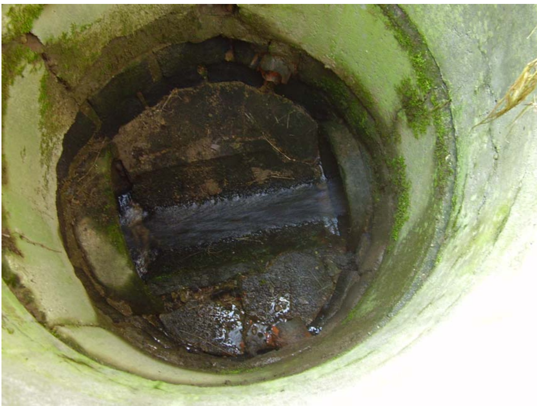
Příloha 7. Funkční drenážní šachtice Š3, Jenín 2
