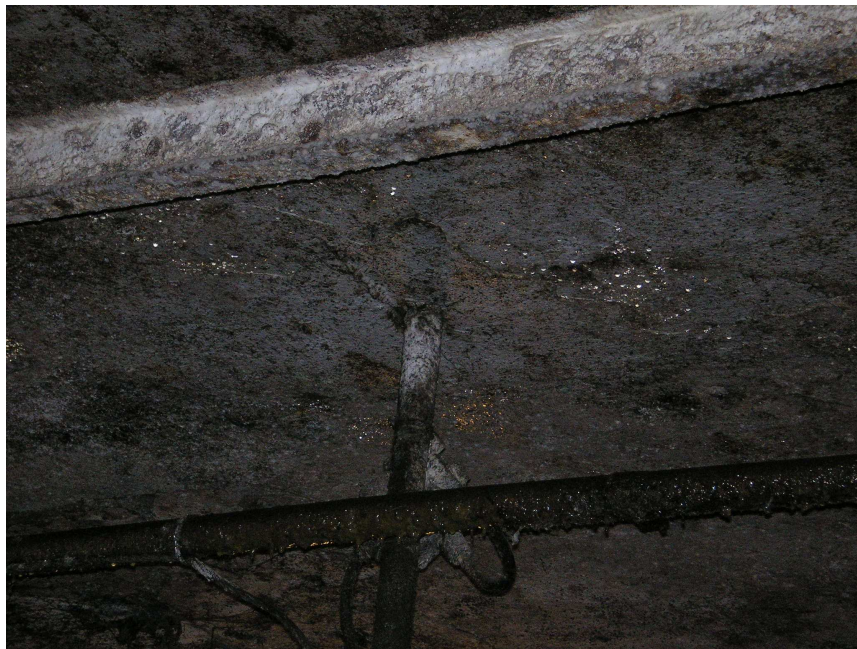
Foto 6 - Kondenzování vody na stropě - vazná stáj
