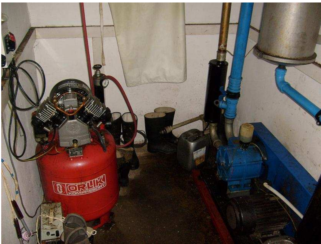
Obrázek 8.1.10. Strojovna s kompresorem
