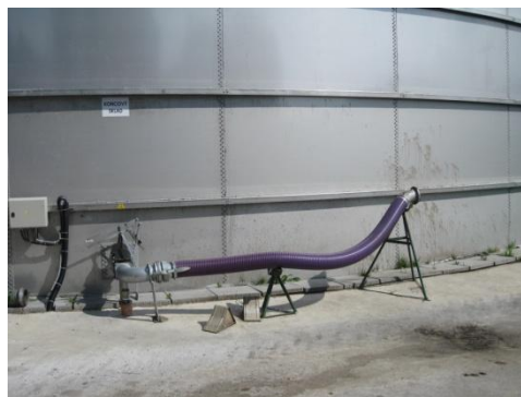
Obr. č. 40 – Homogenizační jímka
