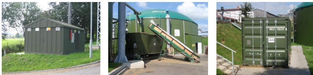
Obr. č. 31 – Trafostanice, dávkovací zařízení, velín
