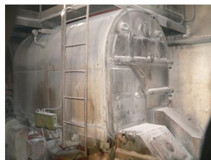
Obr. č. 35- Stávající kotelna
