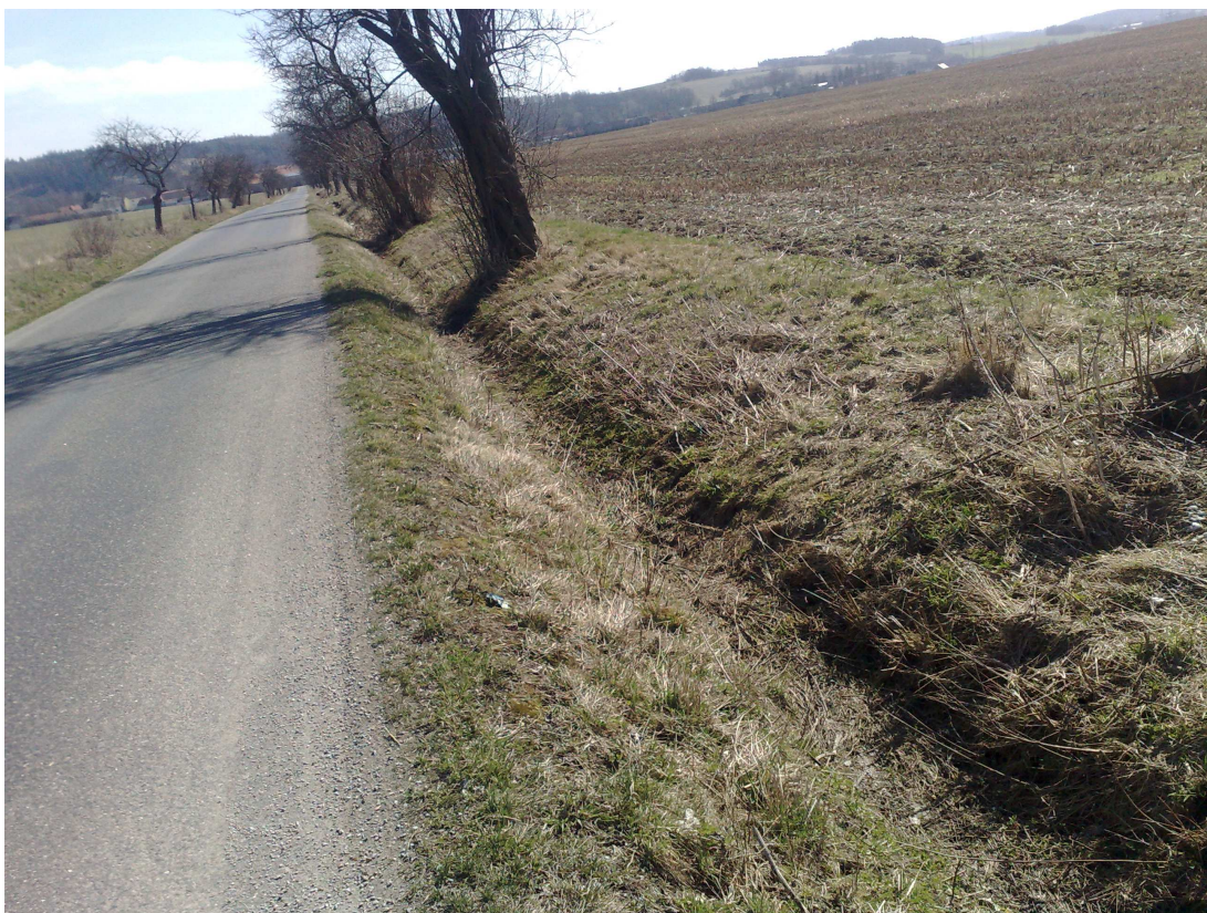
Obrázek 7 - Stav cestních příkopů.
