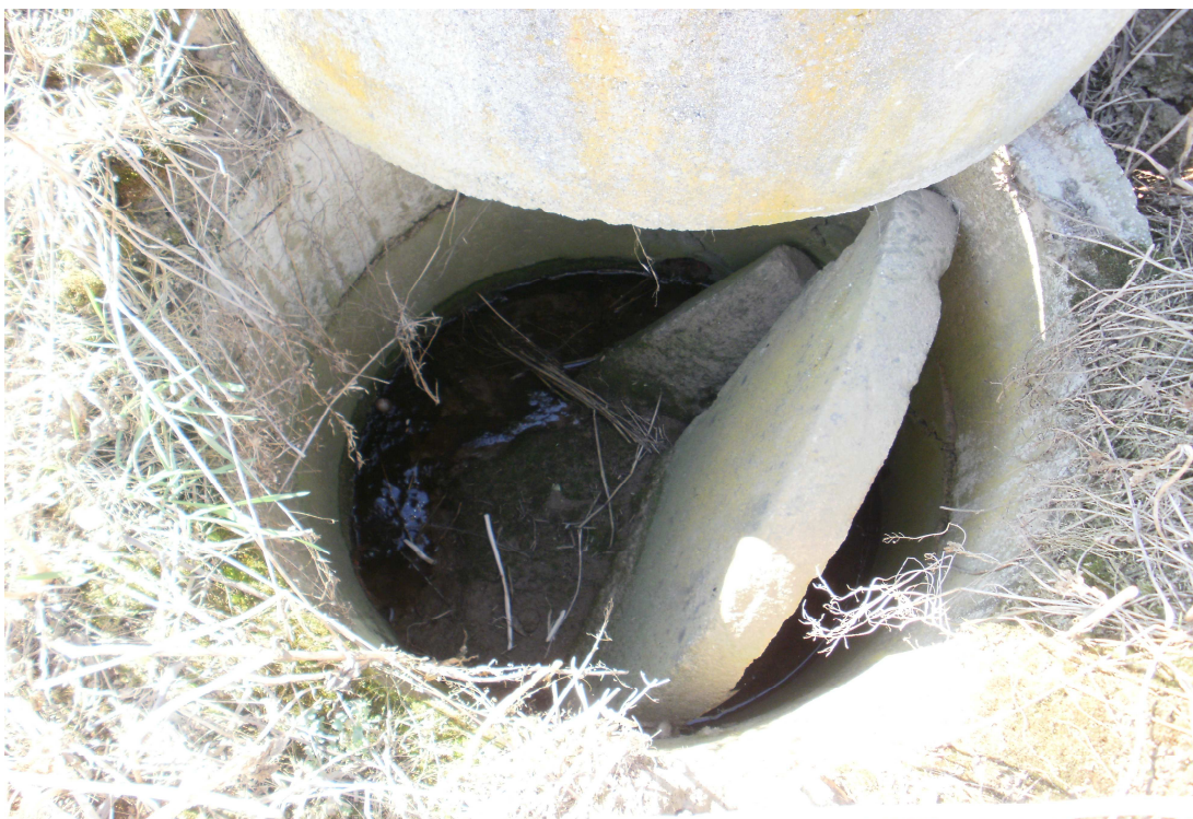
Obrázek 6 - Zhoršená funkce drenáže, špatná údržba.
