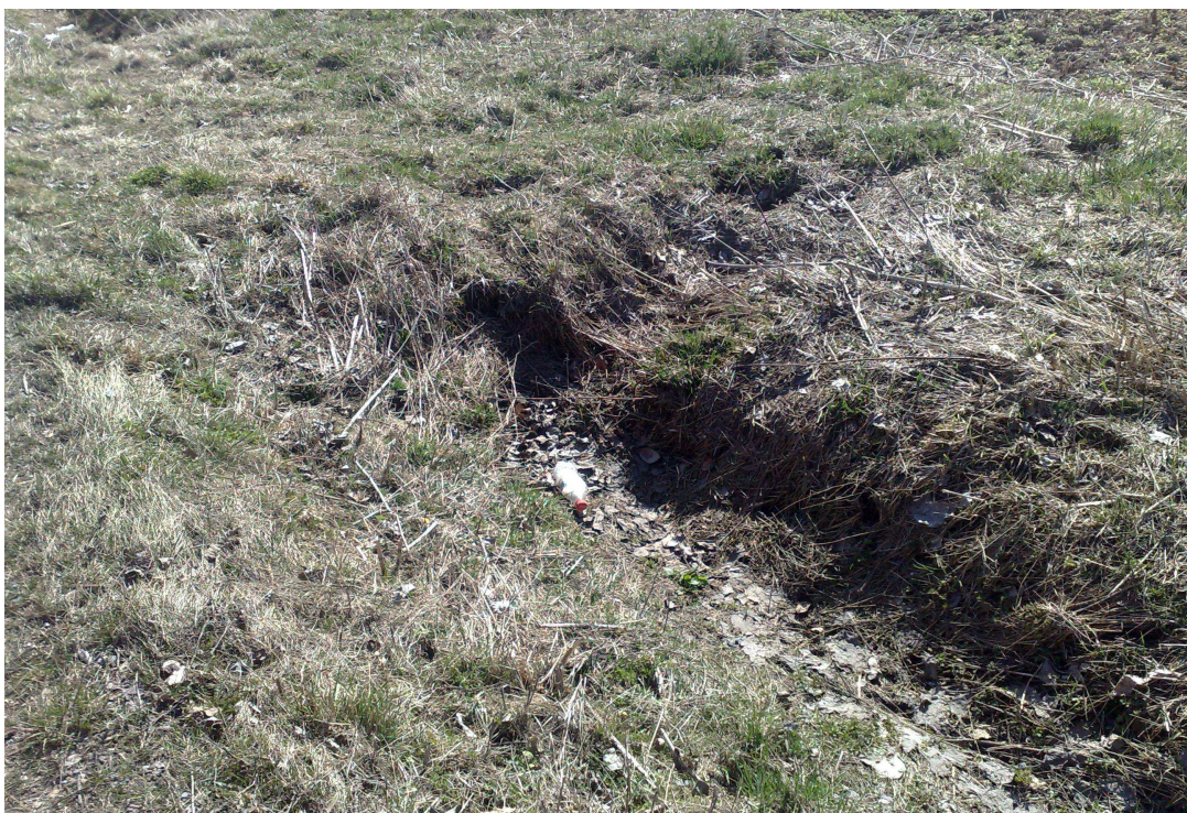
Obrázek 8 – Nefunkční propustek pod sjezdem na pole
