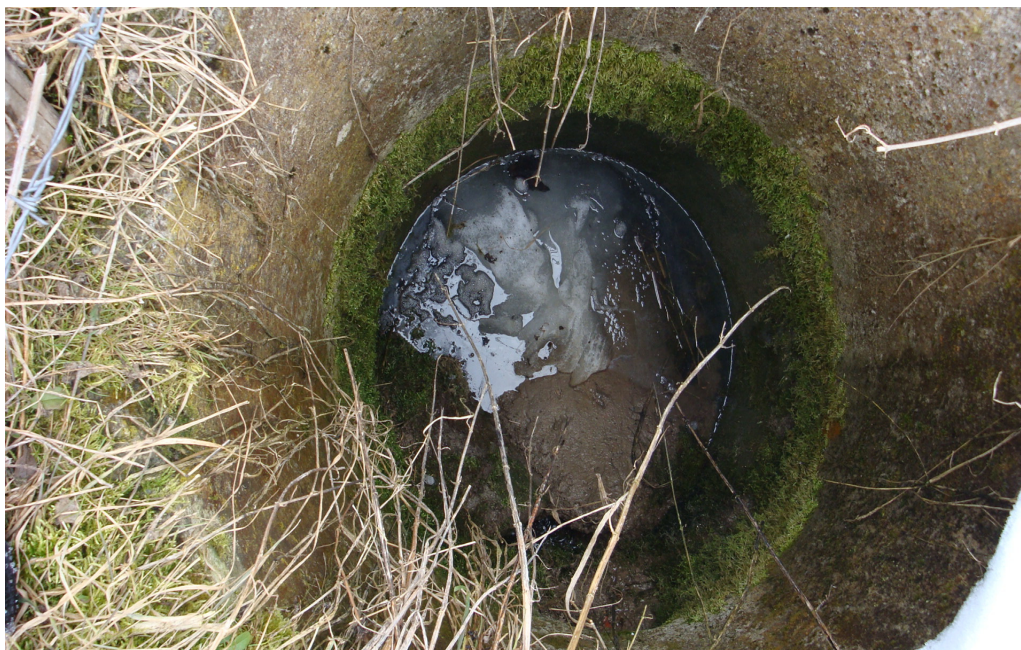
Obr. č. 7: Ukázka nefunkční šachtice- vnitřek
