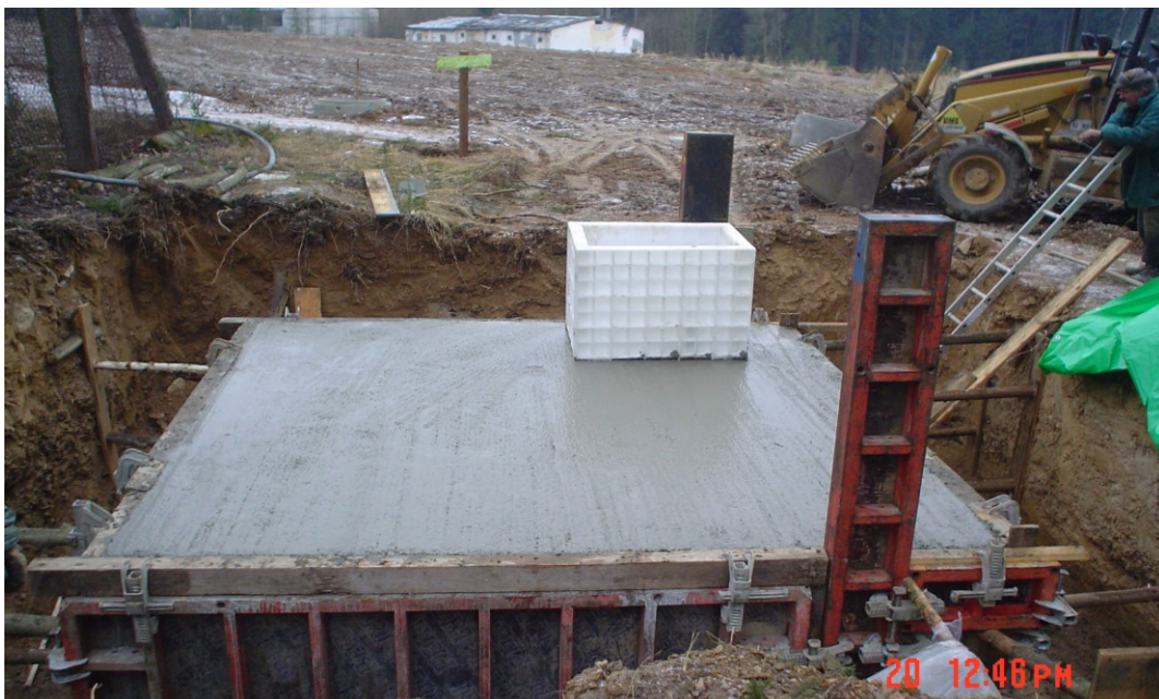
obr. č. 11 Jímka průsakových vod z kompostárny
