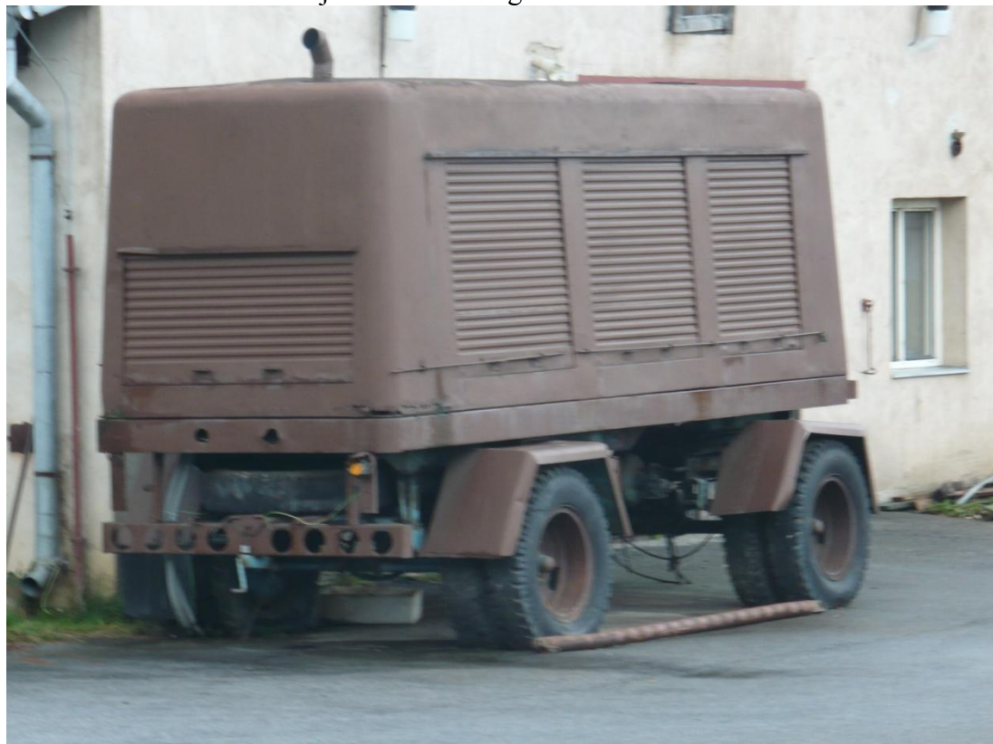
Obrázek 7.1.4 Záložní zdroj elektrické energie
