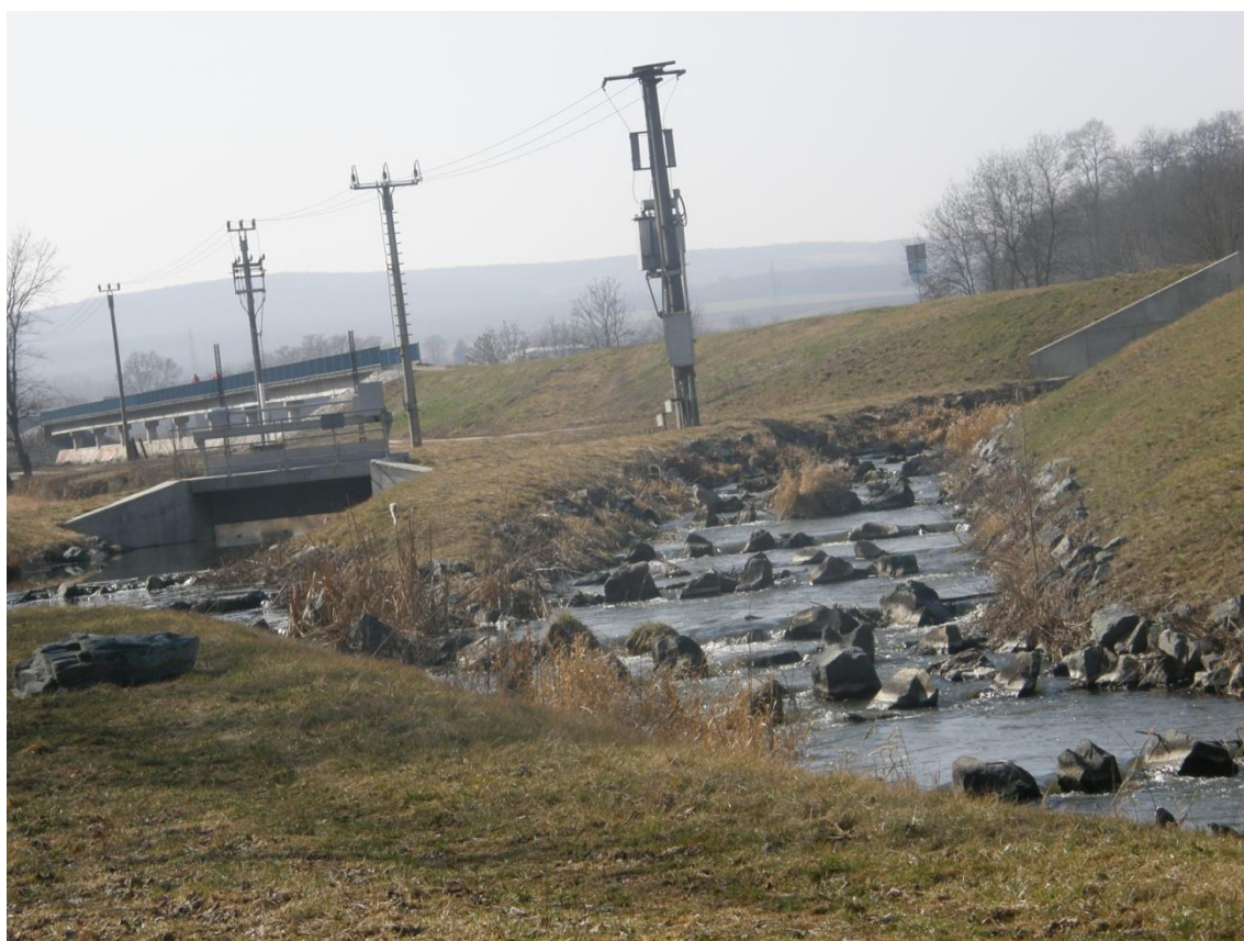
Obr. č. 12: Přírodě blízký 200 m dlouhý rybí přechod u bulharského jezu (foto autor).
