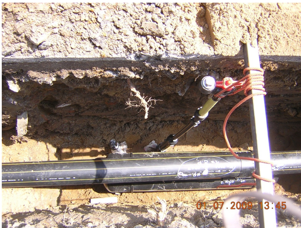
Obr. č. 17: Bioplynovod s odvodňovacím zařízením (Zdroj: Kajan, 2011)
