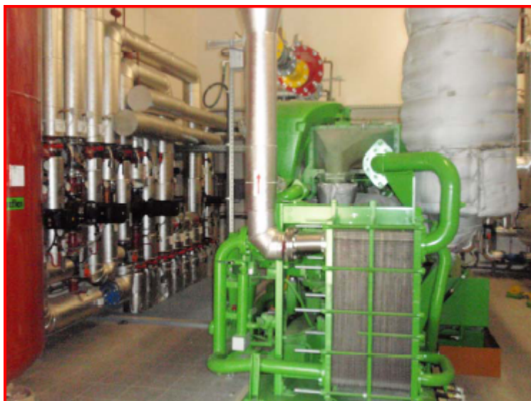
Obr. č. 15: Kogenerační jednotka v budově bioteplárny lázní (Zdroj: Kajan, 2011)
