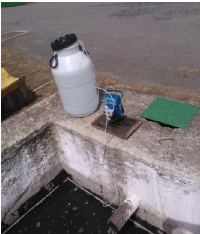
Obrázek č. 4: Instalace peristaltické pumpy na přítok sádky (foto Eliška Zusková).
