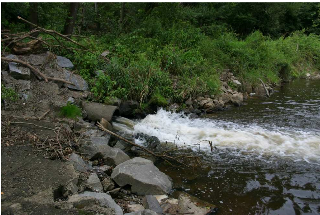
Obr. 23 – Část jezů poškozená erozí v úseku BL013 (Foto: Čampulka, 2011)
