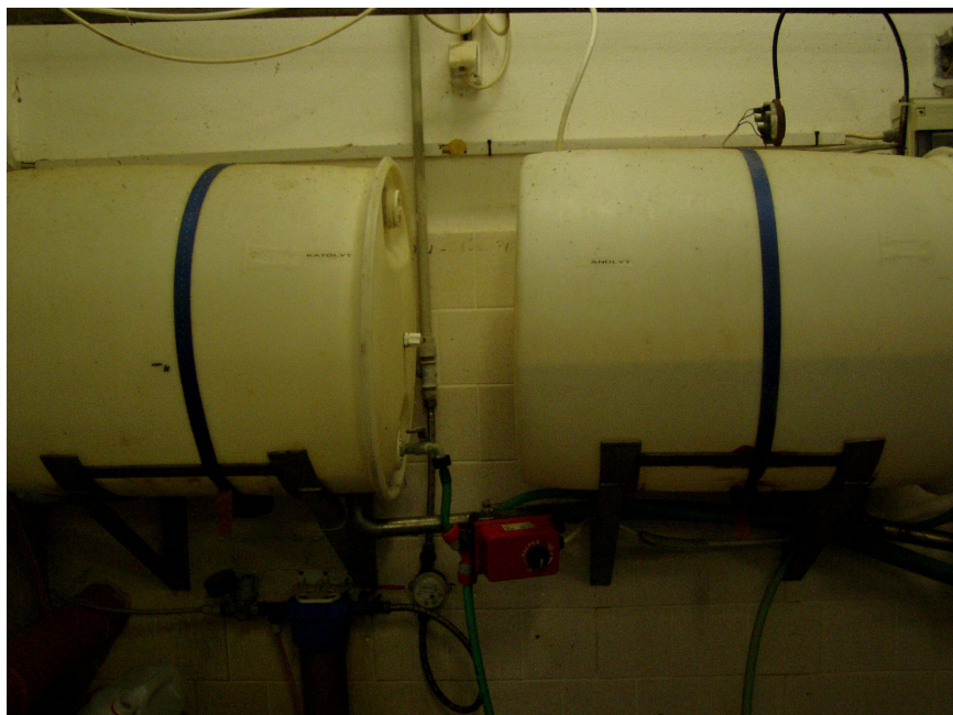
obr. č.8 – nádrže na anolyt (vpravo) a na katolyt (vlevo)
