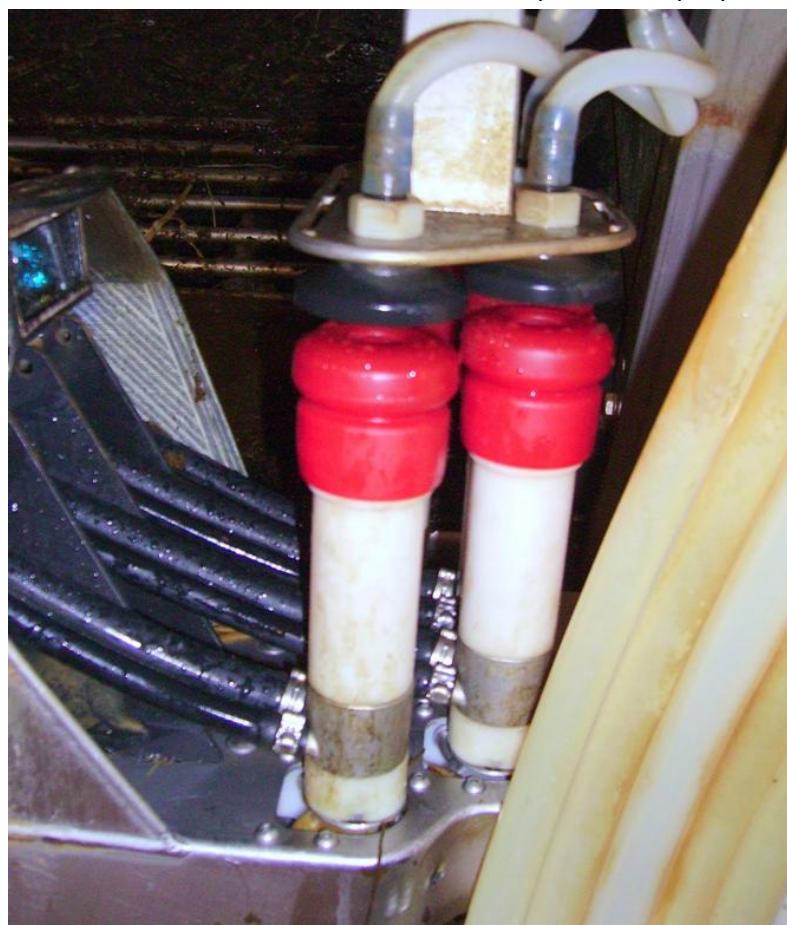
Obrázek č. 4: Pohled na strukové násadce při malém proplachu
