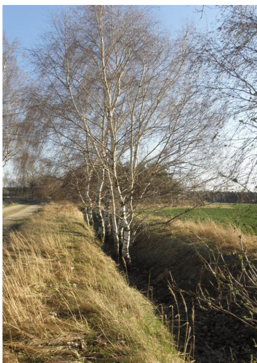
Obrázek 21 – pravostranný příkop je zanesen břízami
