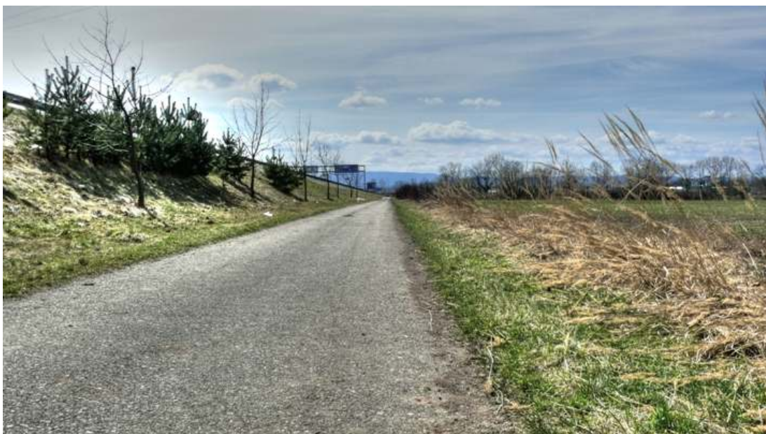
Snímek 3 : Problematické místo s nulovým podélným sklonem
