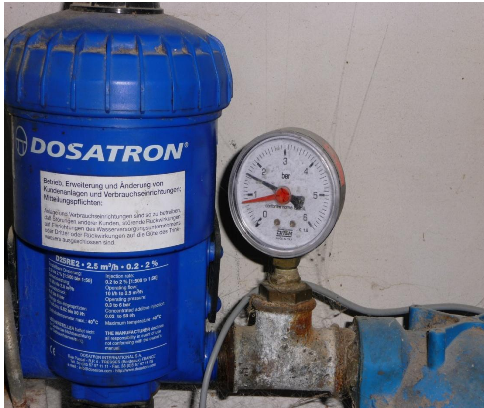
Obr. č. 5 – hodnota tlaku v napájecí soustavě 2 (zvýšená) – hala Dolní Bukovsko – pokus č. 3
