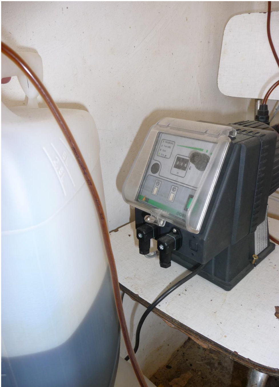
Obr. č. 3 – dávkovací čerpadlo DOSITEC – Dolní Bukovsko – pokus č. 3
