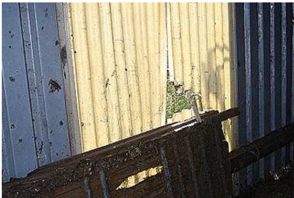
Obrázek 23 – Nedostatečně opravený otvor v plotě
