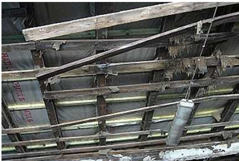
Obrázek 22 – Nedostatečně připevněná prkna
