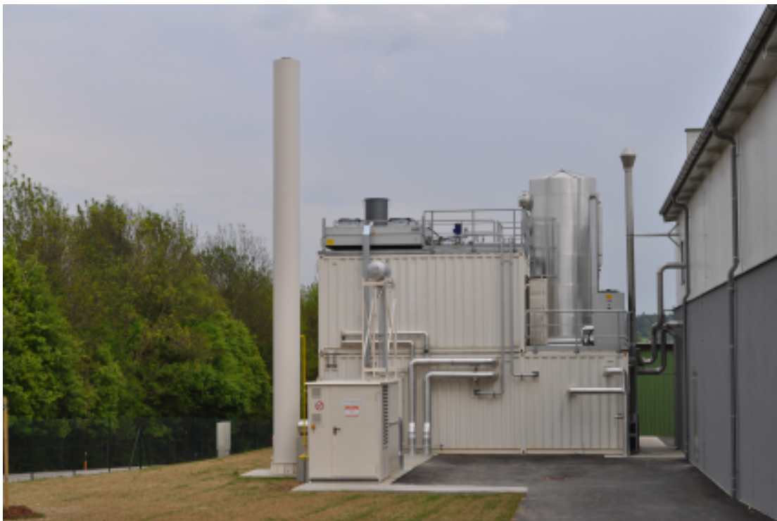
Příloha č. 8 – „Kontejnerové městečko“ obsahující plynový kotel a úpravnu bioplynu u BPS6 (Zdroj: foto Wollner, 2011)
