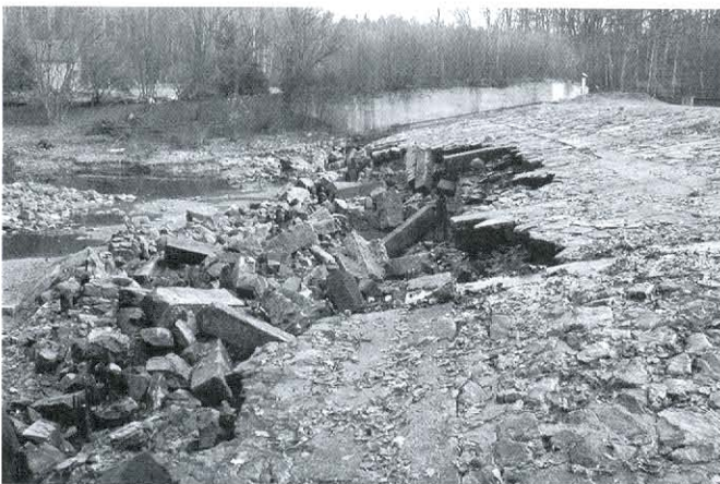
Poškození bezpečnostního přelivu Rožmberka, říjen 2002 (foto autor)
