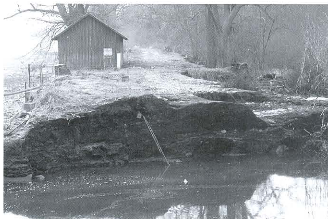
Obr. 8 – Protržená hráz rybníka Nový Vdovec – patrná homogenní zemní hráz (foto autor)
