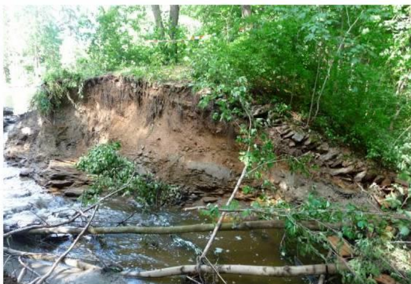
Obrázek 51 Průrva v místě bývalého nouzového přelivu [51]
