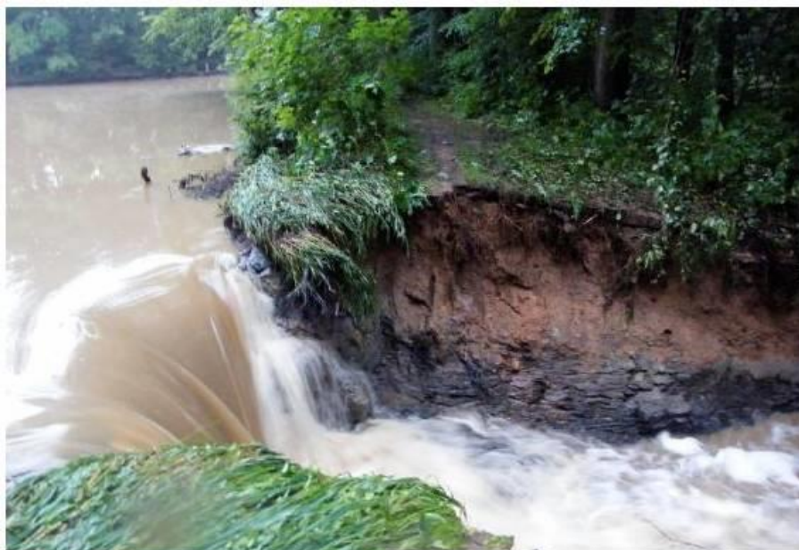
Obrázek 50 Přelévání hráze v místě průrvy bývalého nouzového přelivu [36]
