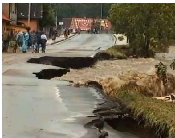
Obrázek 36 Podemletá pozemní komunikace [20]
