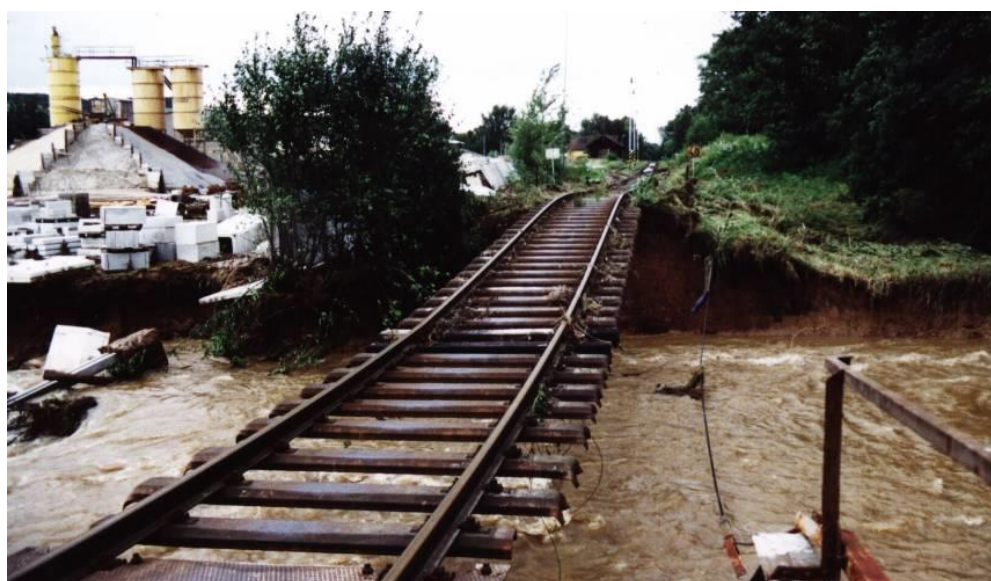
Obrázek 37 Spadlý železniční most [29]
