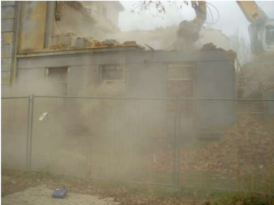
Obrázek 29 – vylétnutí prachu skrze okna a následné rozvíření o zem
