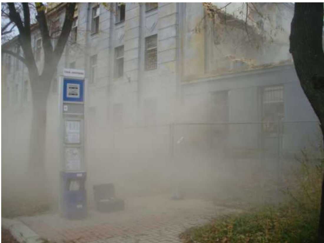
Obrázek 30 – plné rozvíření prachu v prostoru zastávky (v případě demolice této stěny nebylo dýchatelno)
