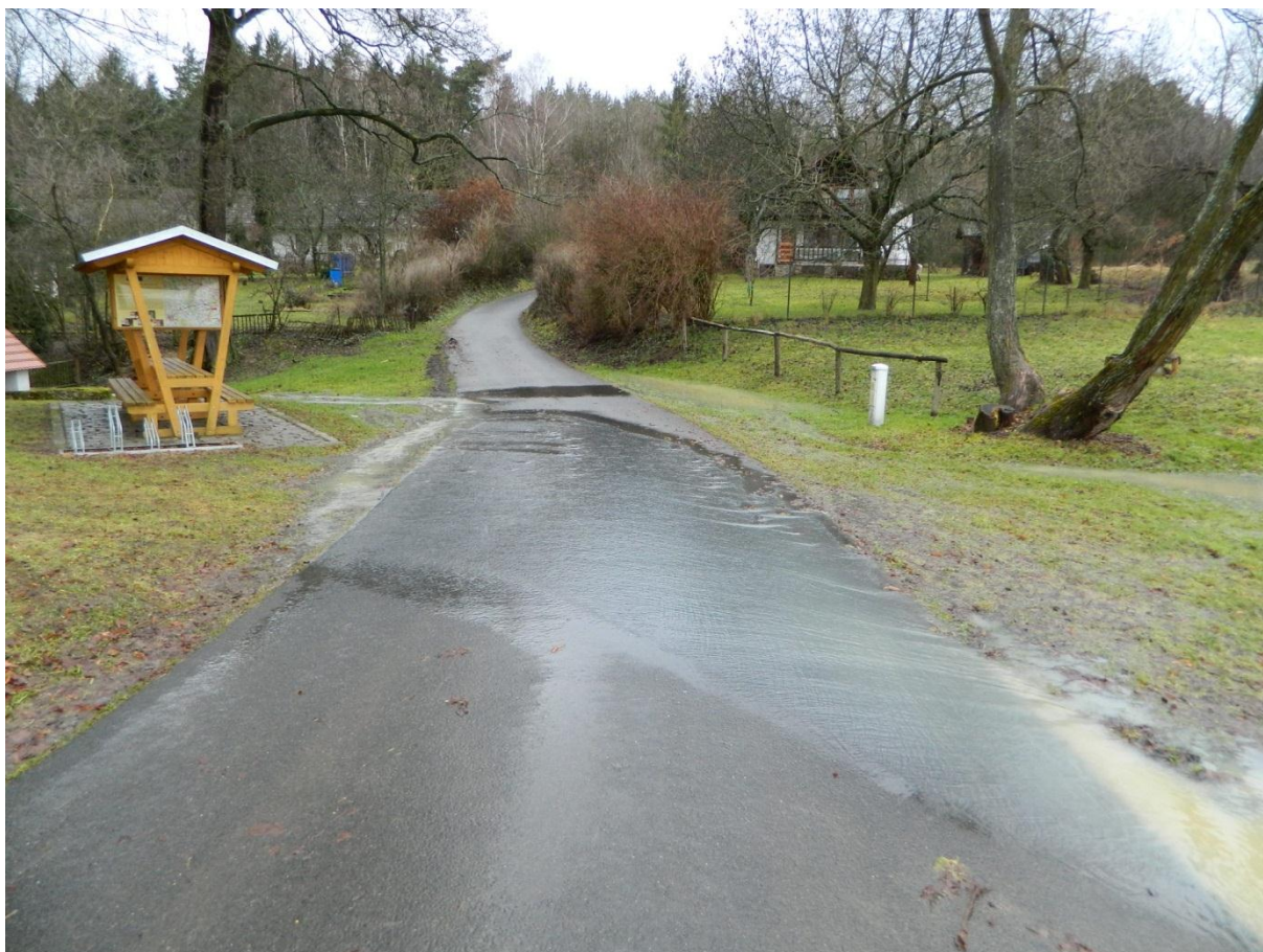
Obrázek 1 Nevyřešené odvodnění cesty před kaplí Sv. Rosalie (C2), zdroj: autor
