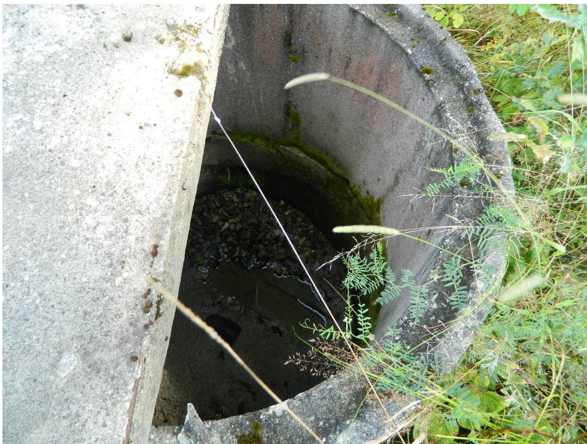
Obrázek 3 Nefunkční drenážní šachtice, zdroj: autor
