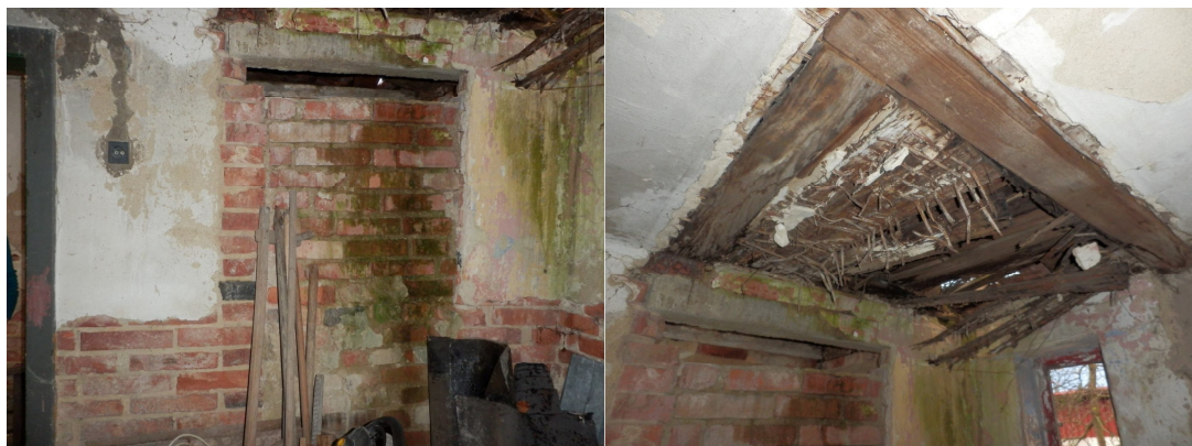
Foto č. 10: Starší část maštali s porušenou stropní kcí („Foto Sandra Studená“)
