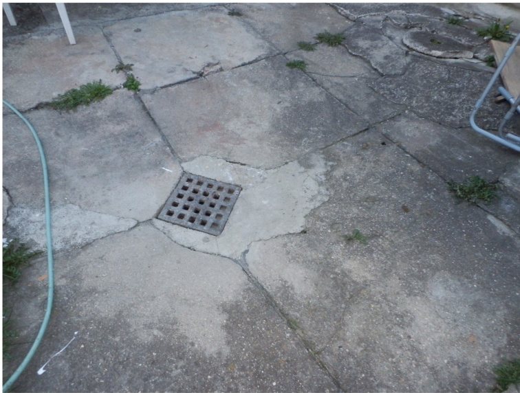
Foto č. 12: Kanalizační vpust' odvádějící dešťovou vodu z dešťových svodů („Foto Sandra Studená“)
