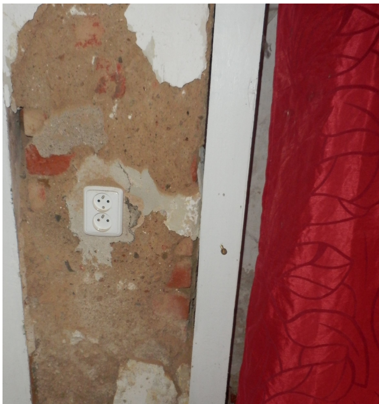
Foto č. 9: Vzorek č. 9; pohled F – Porušené ostění u vchodu na dvůr („Foto Sandra Studená“)
