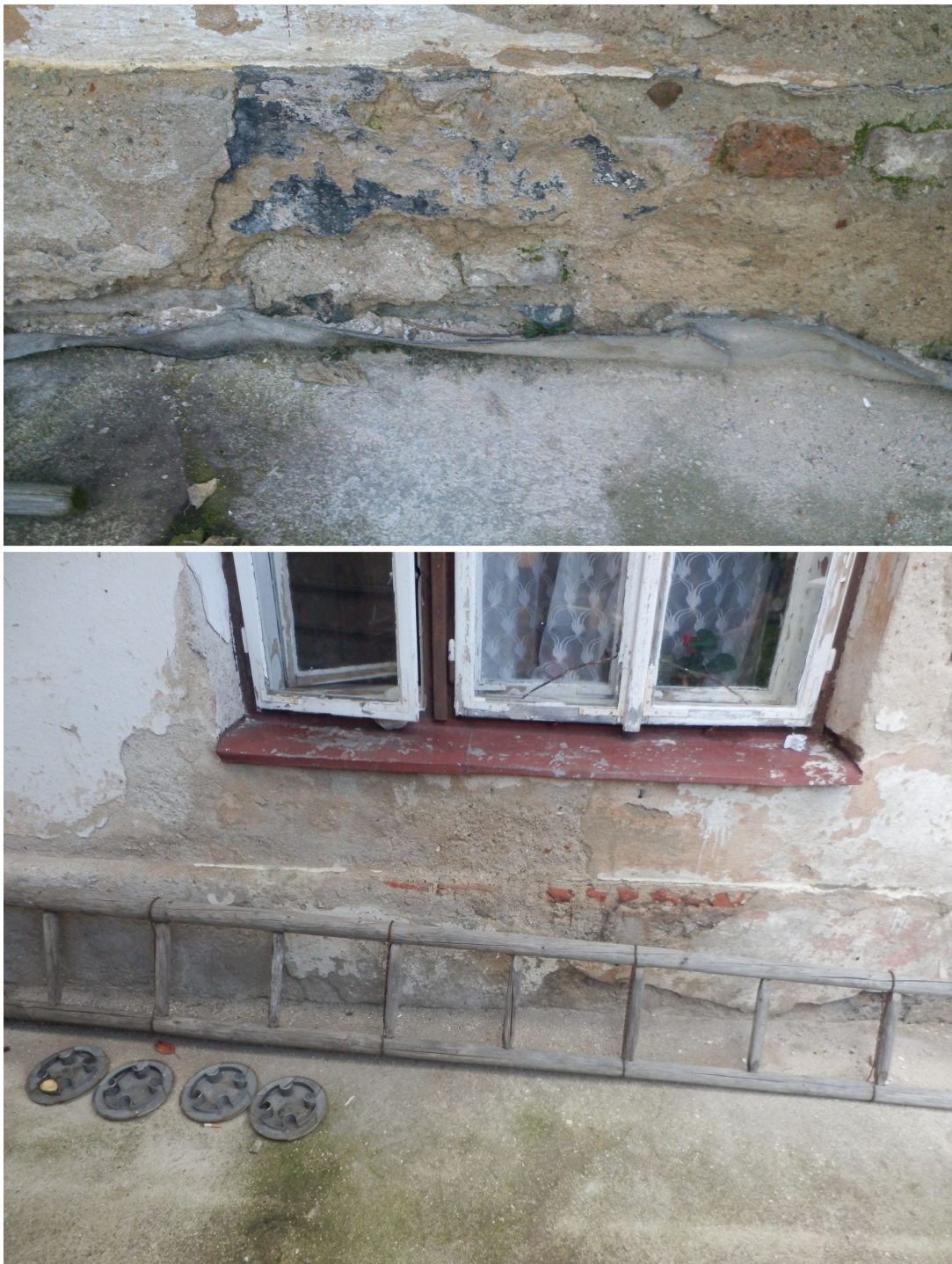
Foto č. 4: Vzorek č. 1; pohled A - Obvodová zeď s viditelnou starou asfaltovou hydroizolací („Foto Sandra Studená“)
