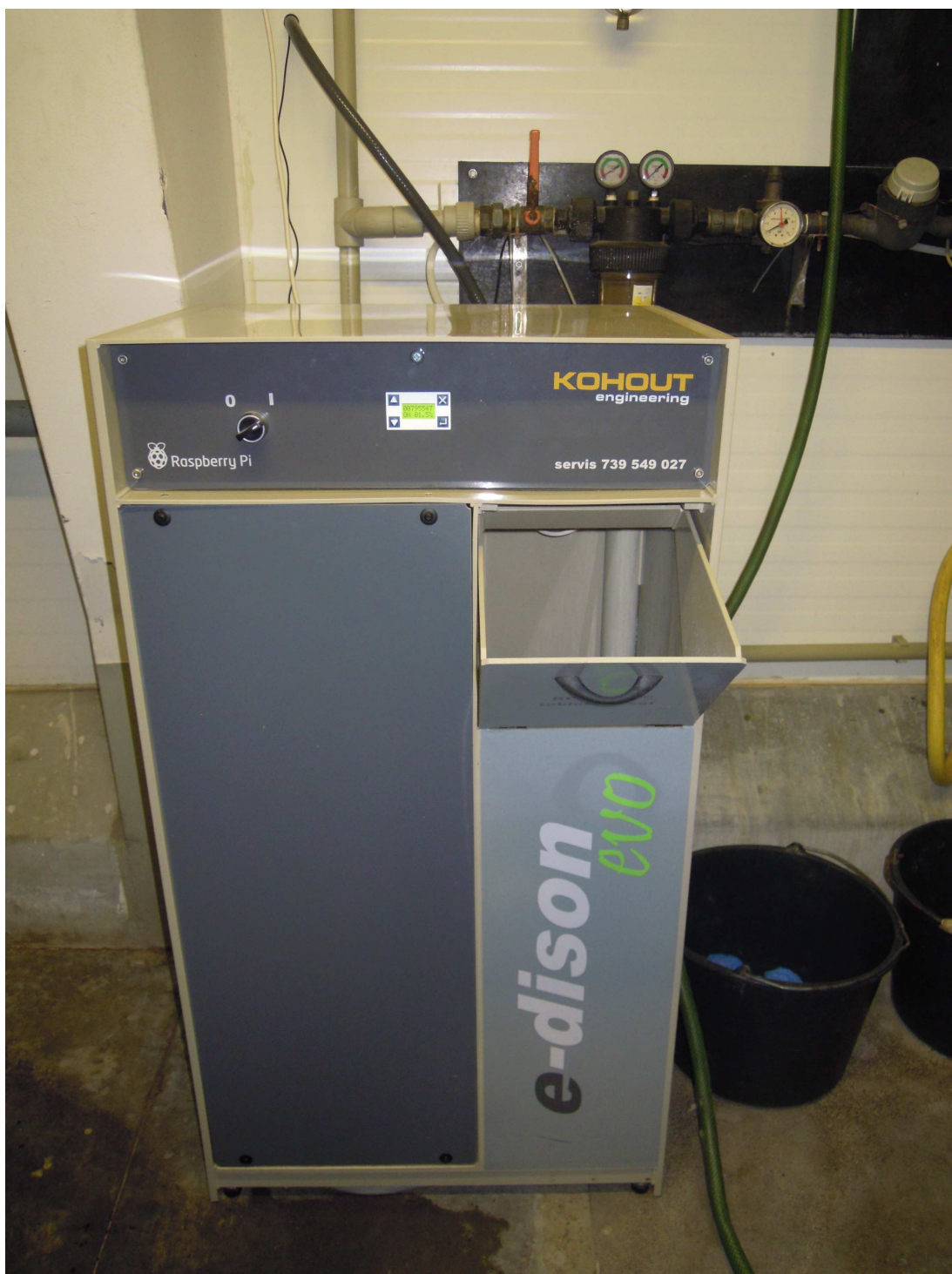
Obr. 9 Zařízení na úpravu napájecí vody e-dison evo se dvěma moduly (otevřen zásobník na sůl) (foto: autor)
