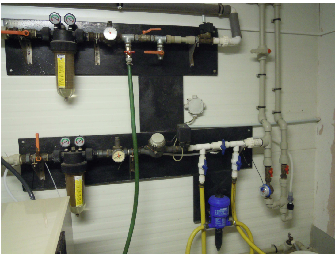
Obr. 11 Systém úpravy vody, vpravo dole dávkovácí zařízení anolytu, směrem doleva medikátor a nad sebou umístěné dva vodní filtry (foto: autor)
