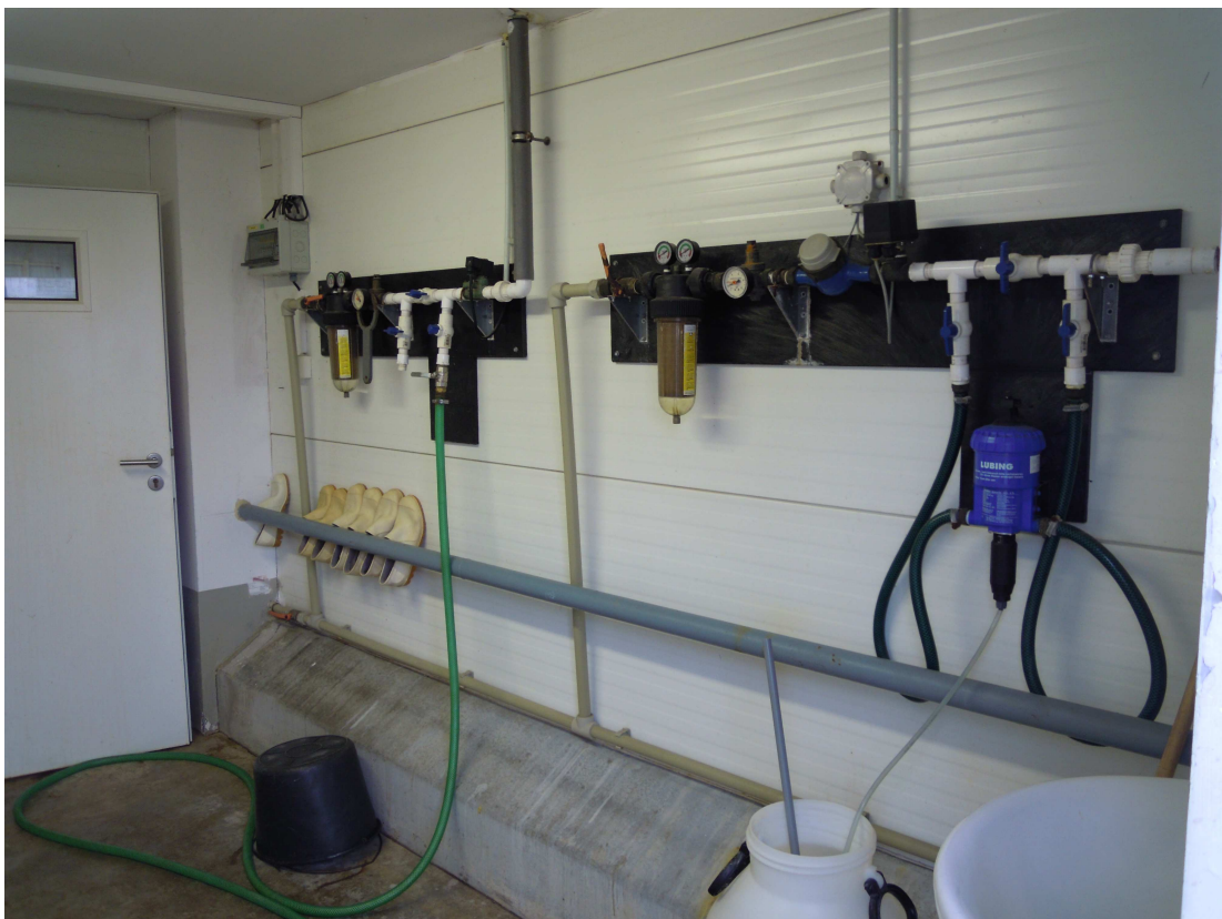
Obr. 7 Prostor velína s technologií úpravy napájecí vody, zprava medikátor a dva vodní filtry (foto: autor)
