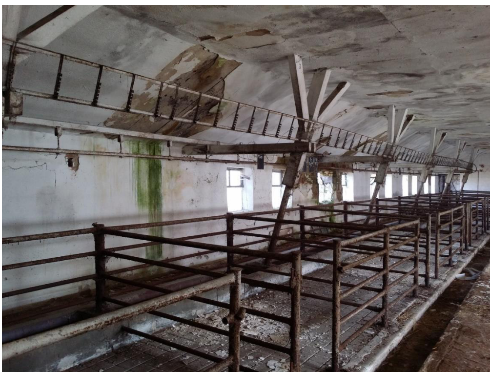
Příloha 8: Fotografie objektu, interiér stáje č.2 – vlhkost zdiva
