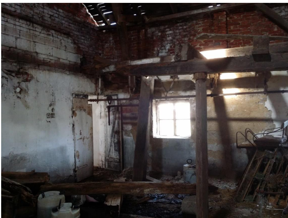
Příloha 10: Fotografie objektu, interiér skladu – porušený krov
