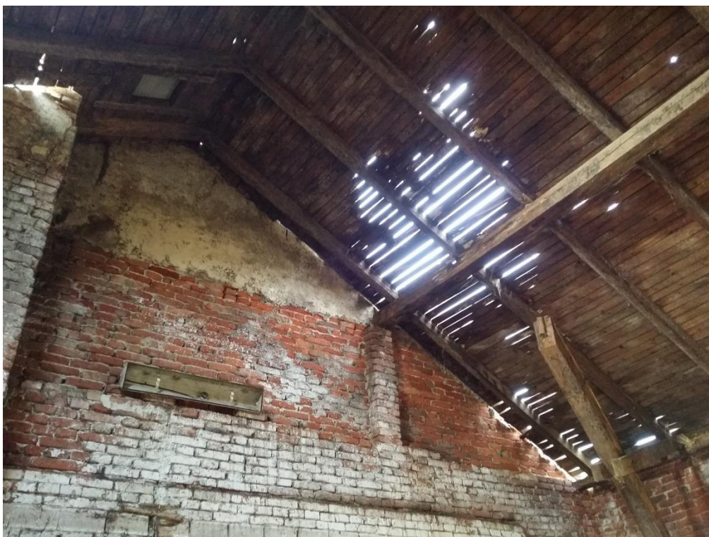
Příloha 9: Fotografie objektu, interiér skladu – porušená střešní krytina a krov
