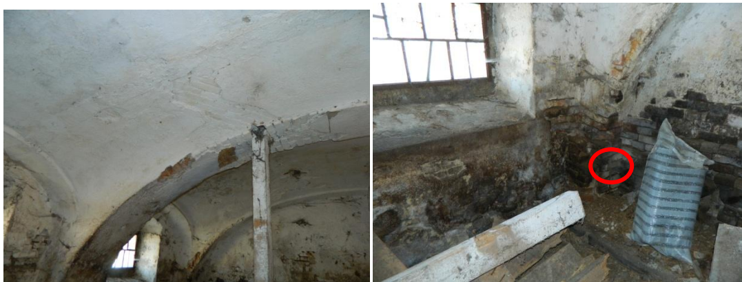
Obr. č. 11, 12: Opadaná omítka a mechanické porušení zdiva
