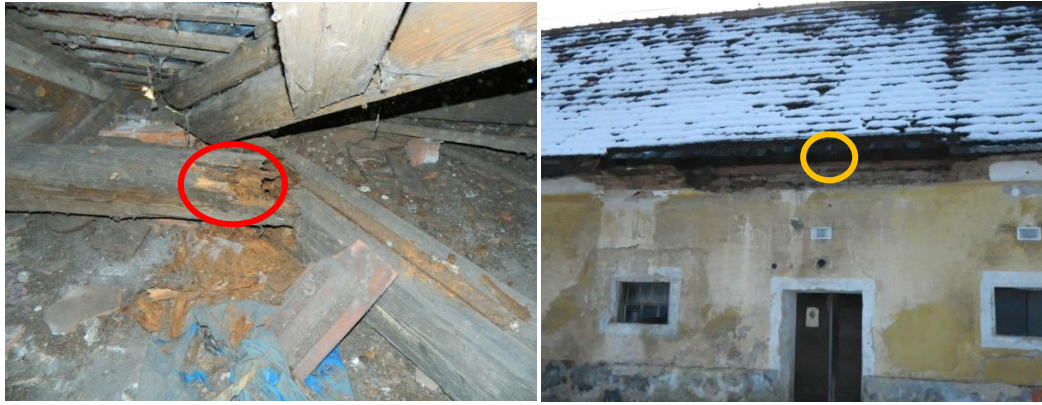
Obr. č. 14, 15: shnilý spoj pozednice a vazného trámu
