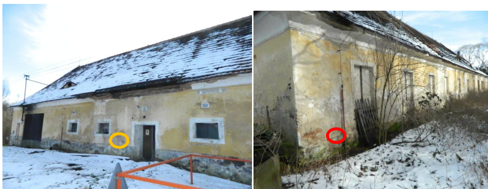
Obr. č. 9,10: Zřícená římsa na přední části objektu, zadní část objektu u řeky
