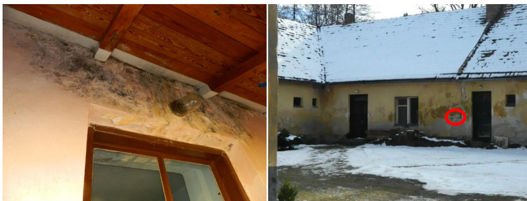
Obr. č. 7,8: Vlhkost zdiva ve vchodu do bytu č. 1 a na nádvoří
