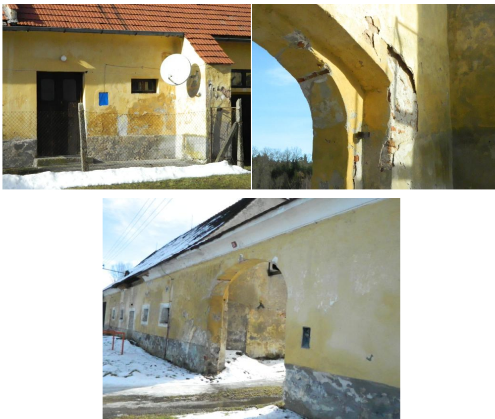
Obr. č. 18, 19, 20: Vlhkost omítky
