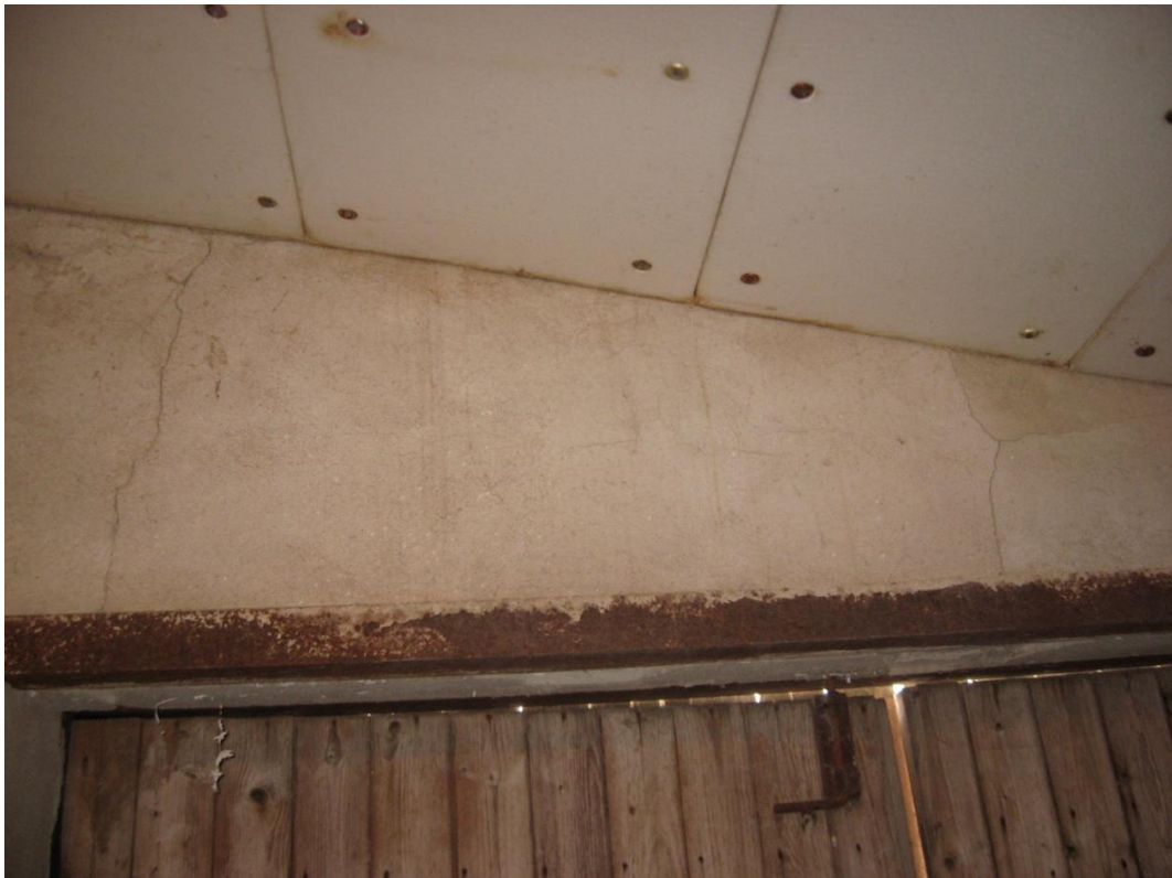
Obr. č. 6 - Trhliny ve zdivu u stávající haly (Zdroj: vlastní šetření)
