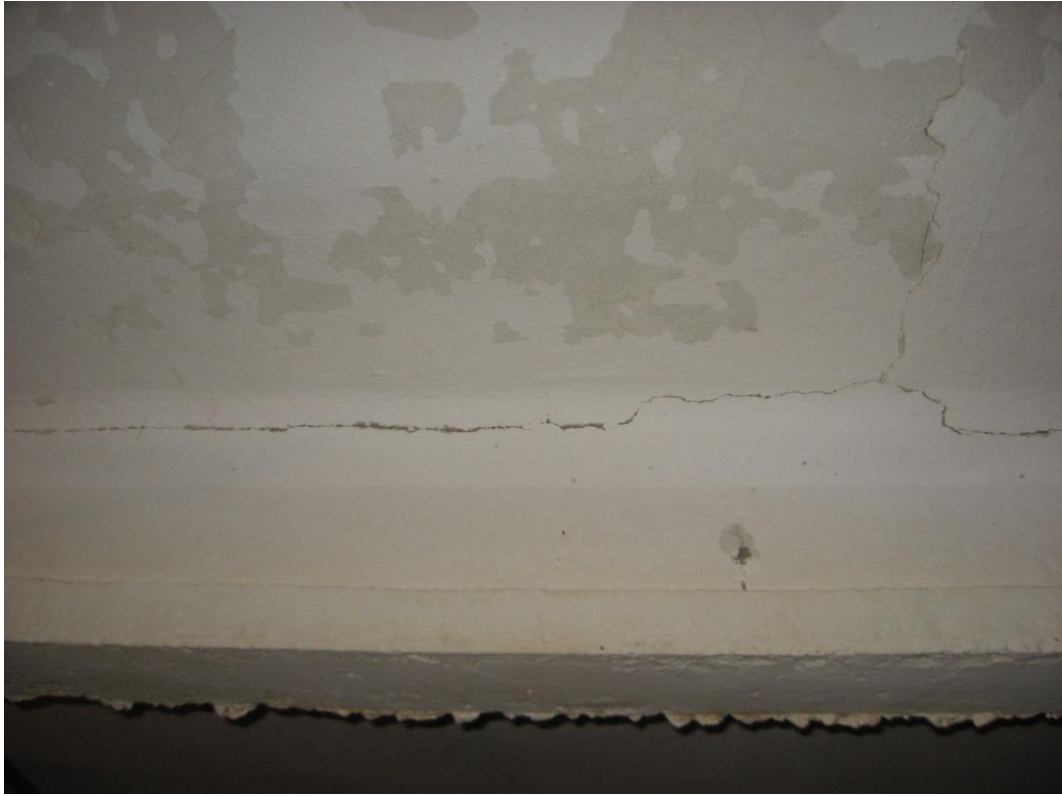
Obr. č. 5 - Trhliny ve zdivu u stávající haly (Zdroj: vlastní šetření)
