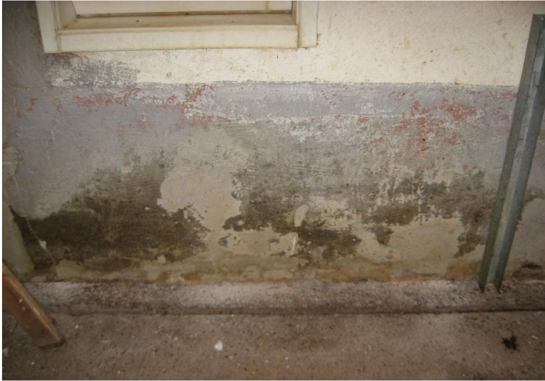
Obr. č. 3 - Vlhké zdivo u stávající haly
