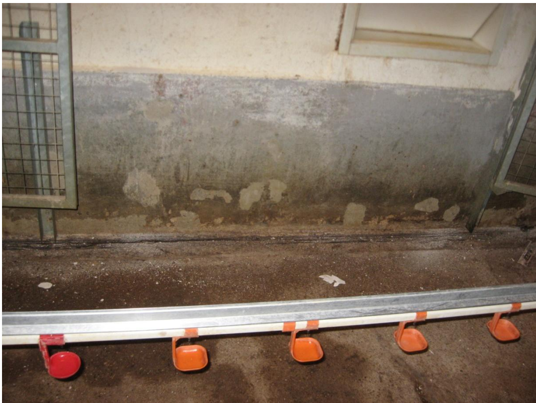
Obr. č. 4 - Vlhké zdivo u stávající haly
