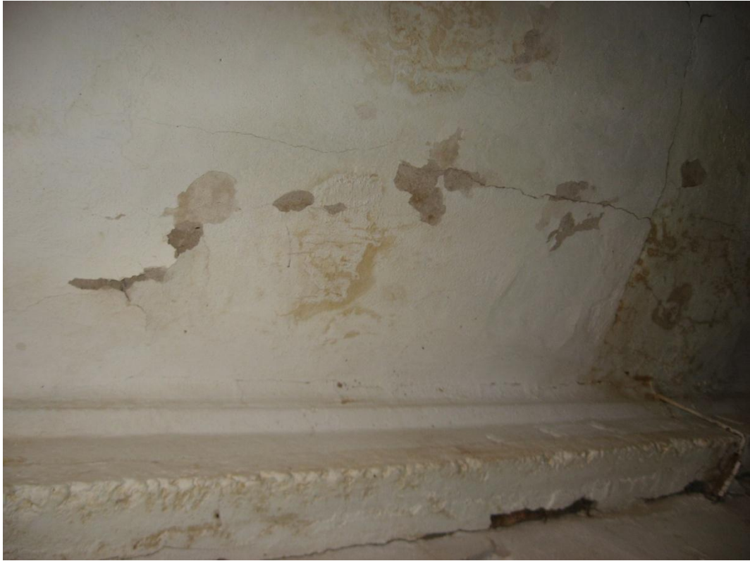
Obr. č. 7 - Trhliny ve zdivu u stávající haly (Zdroj: vlastní šetření)
