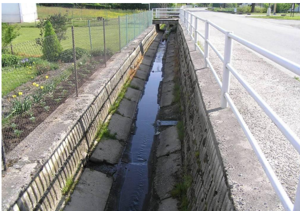
Obr. č. 2: Betonové opevnění Děbolínského potoka v obci Děbolín u J. Hradce zdroj: vlastní foto
