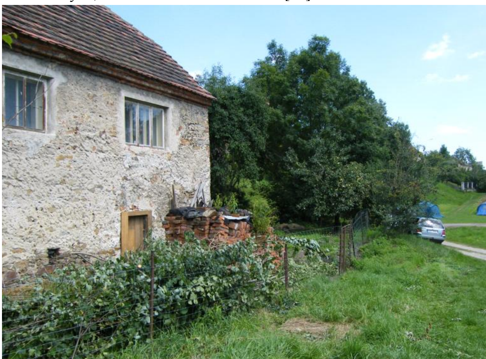
foto 16b, Dnešní pohled na domek čp. 90, 1. 8. 2012. Z této fotografie je patrné, že domek značně chátrá. Kde vedla mlýnská stoka, tak tam je dnes místo pro stanování. Částečně je vidět auto a plocha pro stanování. [28]
