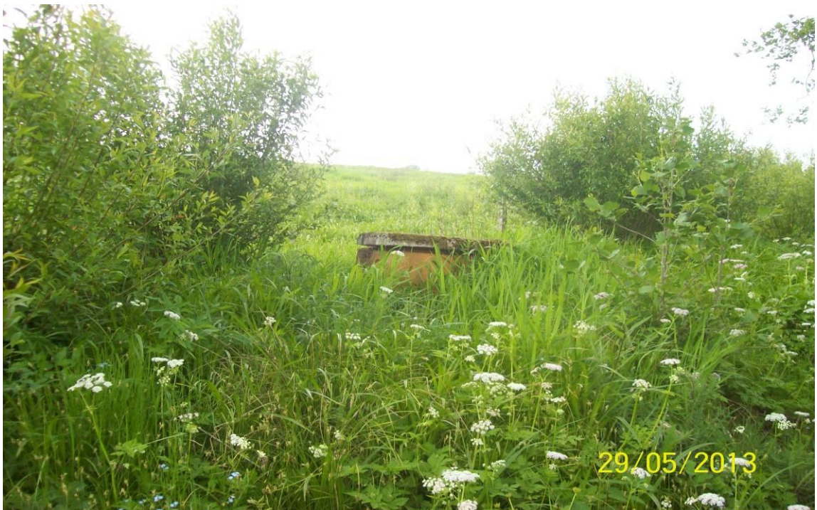
Obr. č. 47 – Betonová šachtice na TTP – AUTOR PRÁCE 2013
