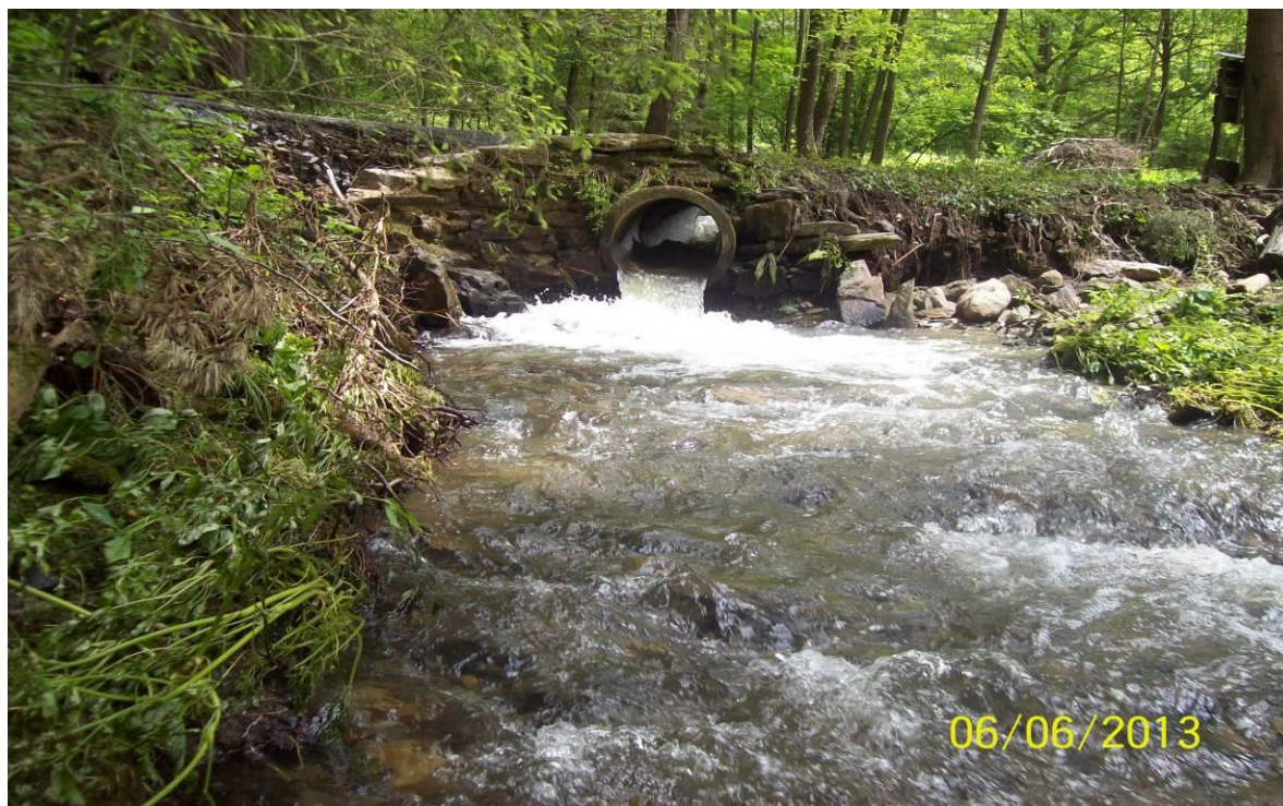
Obrázek č. 29 – Poničený silniční propustek – povodně 2013 – AUTOR PRÁCE
