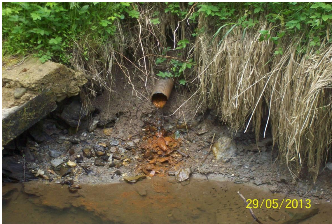
Obr. č. 45 – Vyústění sběrného drénu – provedení PVC – AUTOR PRÁCE 2013
