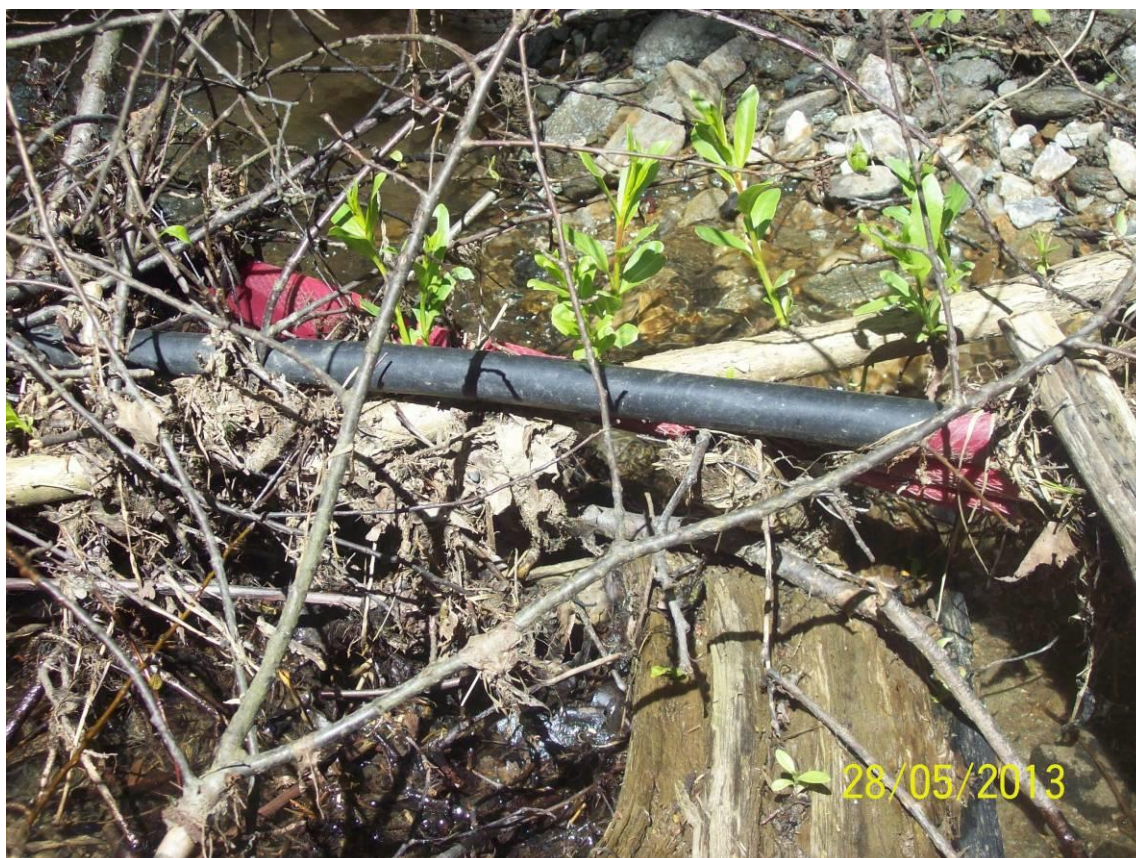
Obr. č. 20 – Nepovolená stavba v korytě potoka - uložení vedení NN – AUTOR PRÁCE 2013
