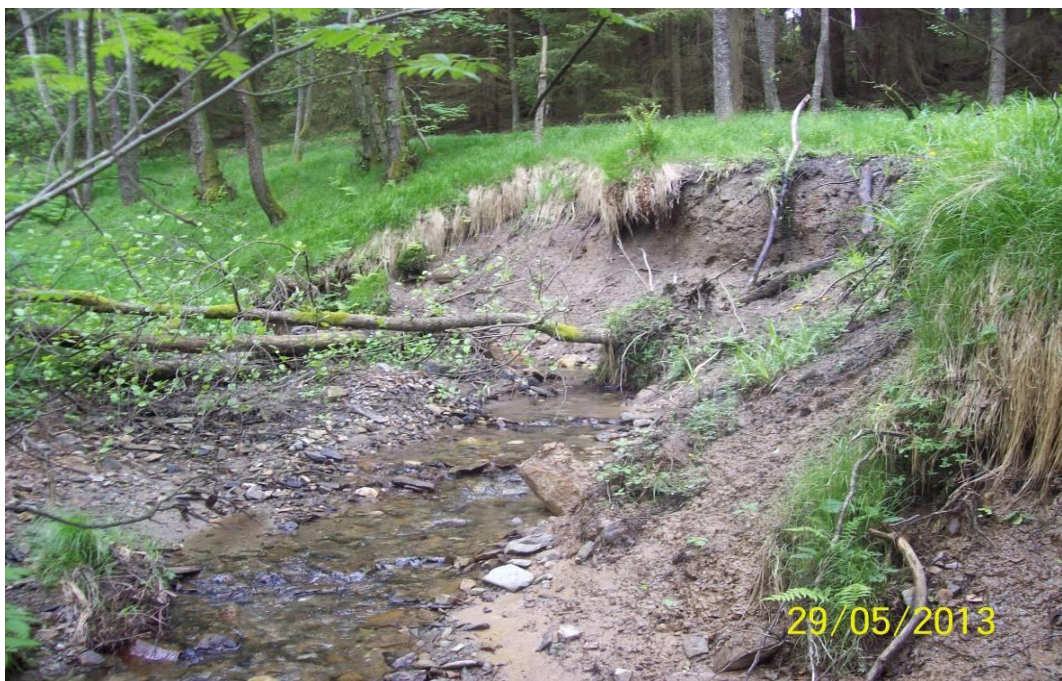
Obr. č. 56 – Břehová eroze - AUTOR PRÁCE 2013
