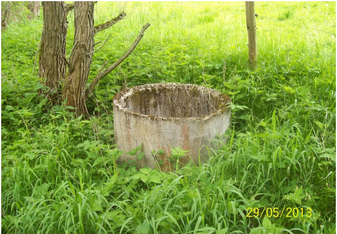
Obr. č.13 – Břehová vegetace a drenážní studna - AUTOR PRÁCE 2013
