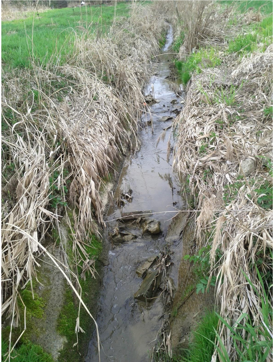
Foto č. 11 – Stav koryta Lišovského potoka ve 3. úseku pod soukromými zahradami (foceno směrem ke 2. vymezenému úseku)
