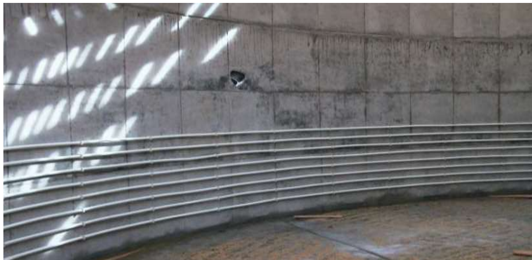
Obr. č. 5: Vytápěcí soustava v reaktoru (Zdroj: Kajan, ENKI, 2006)
