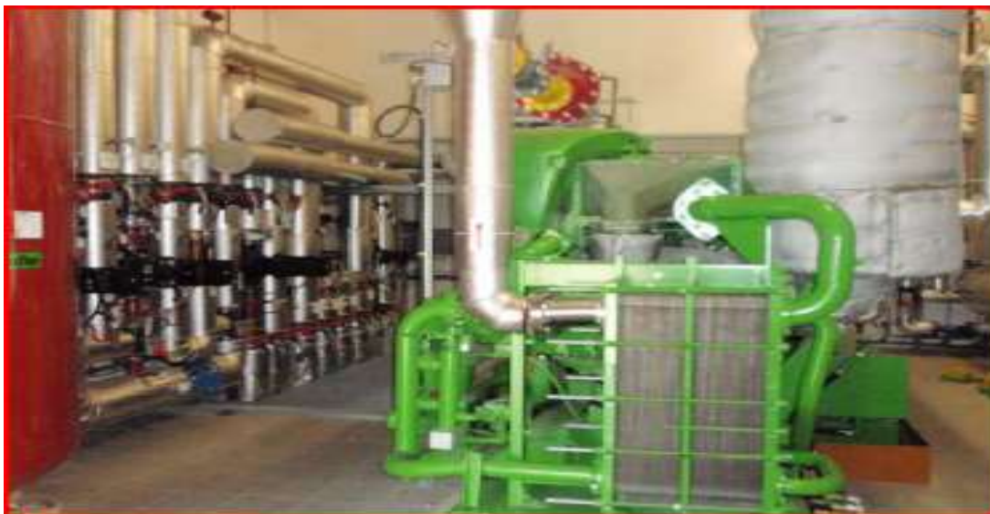
Obr. č. 15: Kogenerační jednotka v budově bioteplárny lázní (Zdroj: Kajan, 2011)
