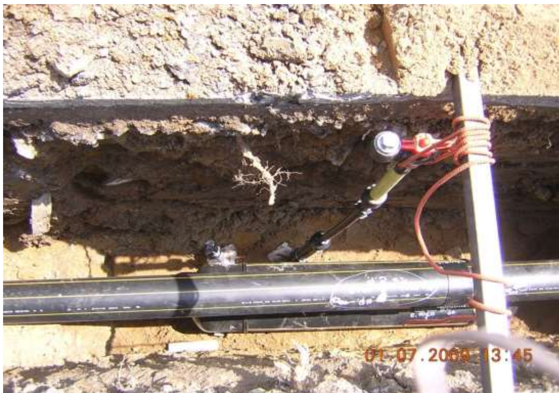
Obr. č. 17: Bioplynovod s odvodňovacím zařízením (Zdroj: Kajan, 2011)
