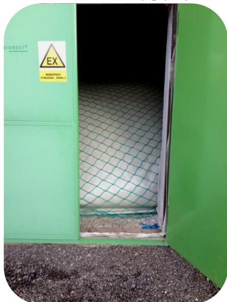
Obr.21 Externě uložený plynojem
