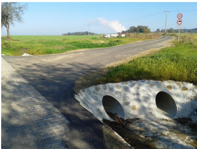
Foto č. 5: C3 – stav po rekonstrukci, asfalt, nově vybudovaný propustek, nová výsadba oboustranné liniové zeleně
