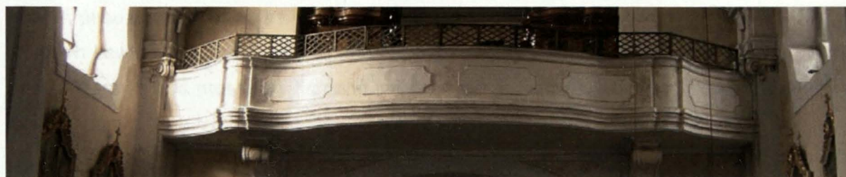
Mřížka na parapetu působí velmi nekompaktně a pravděpodobně nebyla původní součástí
