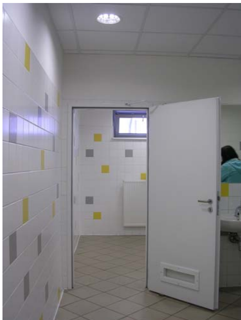
Obrázek č. 23 - stěny na toaletách bez výrazných barevných kontrastů
