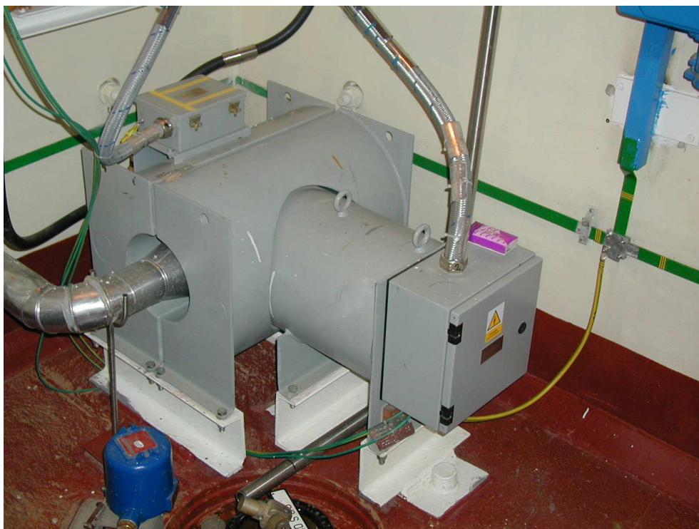
Zařízení pro přímé měření expozičního příkonu na potrubí ATL detektor.
