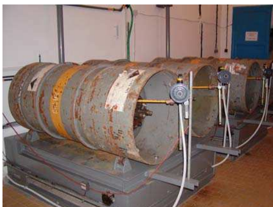
Obr. č. 41: Chlorovací stanice v úpravně vod
