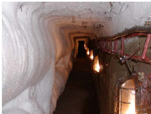
Foto č.2: Potrubí s amoniakem pod ledovou plochou zimního stadiónu
