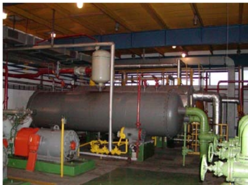
Foto č.1: Strojovna chlazení na zimním stadiónu
