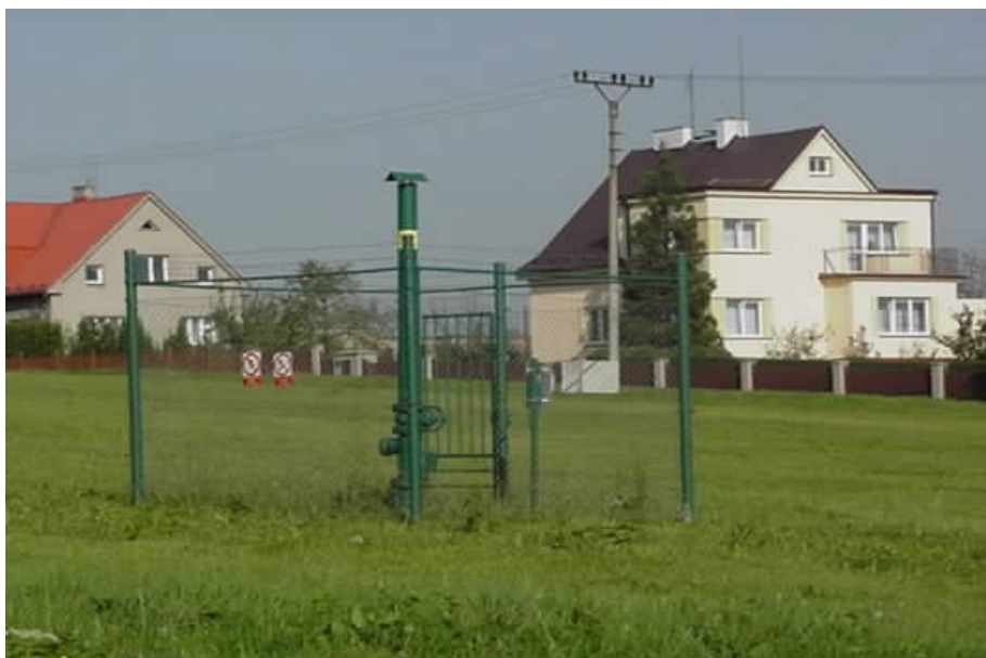
Obrázek 7 : Odvětrávací zařízení v obci Petřvald. [6]
