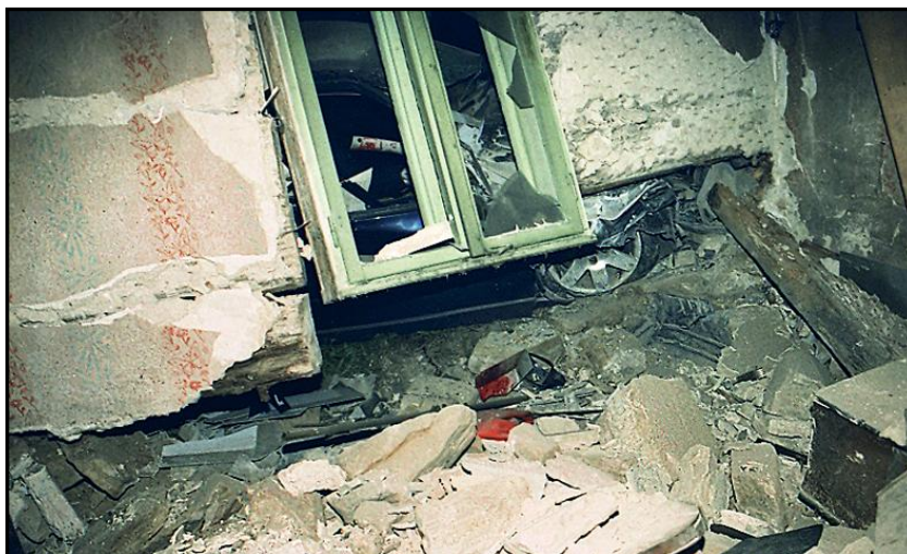
Foto č. 6 – pohled na poškozenou zeď domu po střetu s vozidlem 85)
