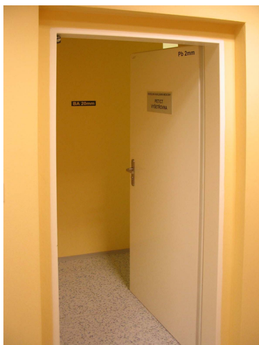
Obr. 1 Labyrint na vstupu do PET-CT vyšetřovny
