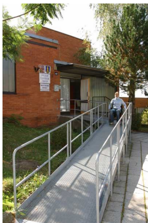
Roštová rampa a výsuvná plošina.
