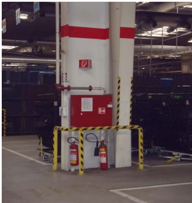
Obrázek 11: Ukázka hydrantu umístěného ve výrobní hale
