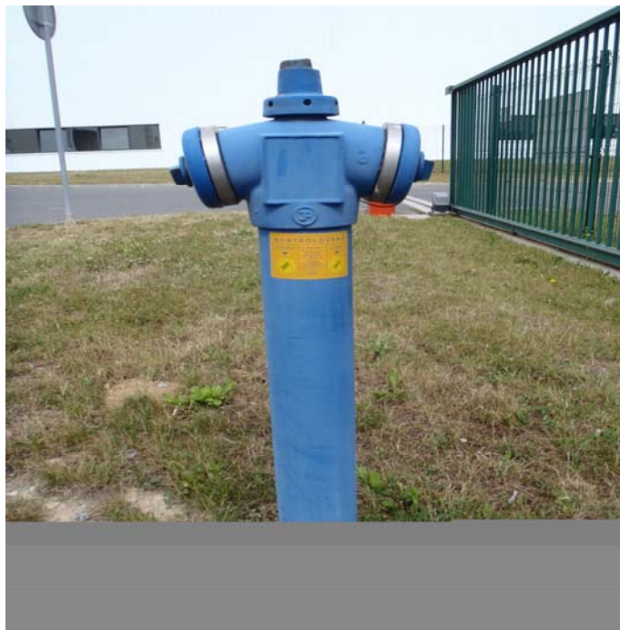
Obrázek 9 : Ukázka venkovního hydrantu v areálu podniku
