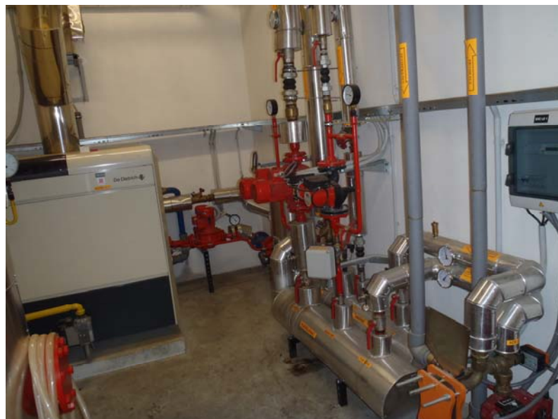
Obrázek 2 : Kotelna s plynovým kotlem o výkonu 200kW
