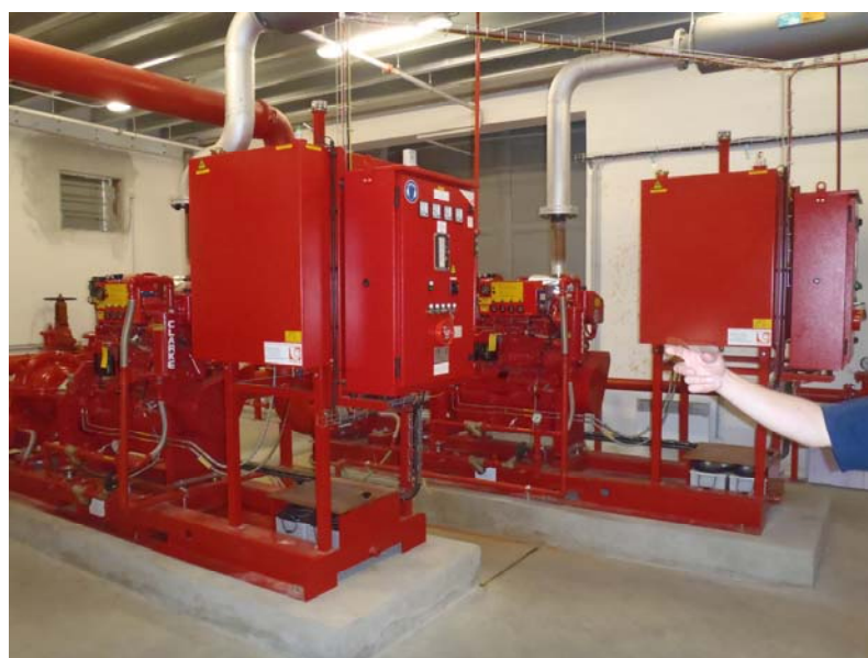
Obrázek 10: Strojovna dieselařegátu pro automatickou řerpací stanici
