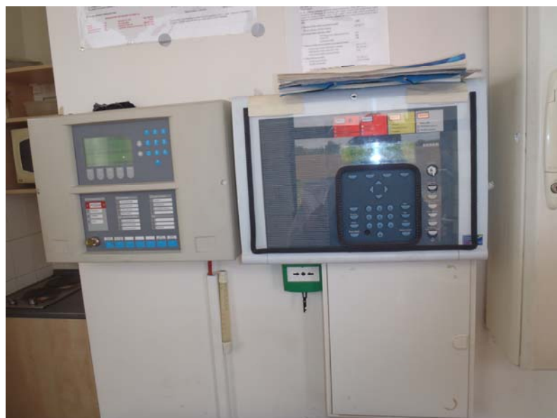
Obrázek 14 : Elektrická požární signalizace v prostoru hlavní vrátnice
