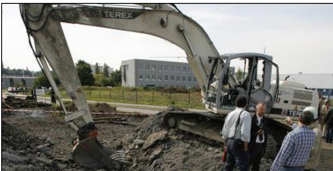
Stavební stroj po výbuchu 250 kg letecké pumy
