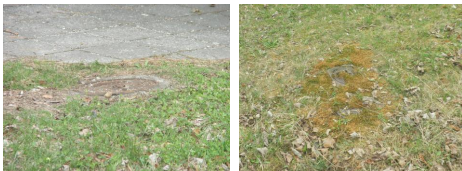
Obr. 5 a 6: Podzemní požární hydranty
