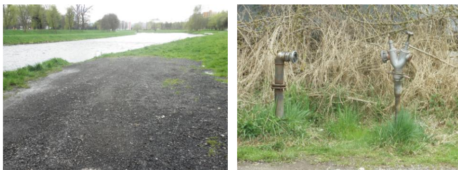
Obr. 7: Čerpací stanoviště – řeka Obr. 8: Čerpací stanoviště – hydrant
